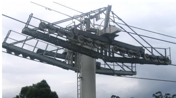
Figura 3. Poleas de pilonas de compresión
