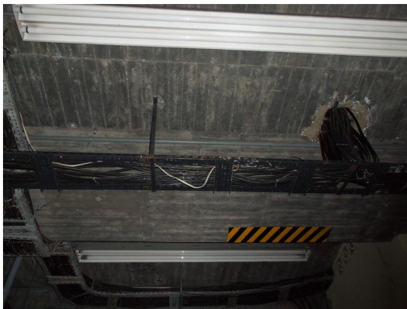
Figura 27. Lampara mala, cuarto de control ccm Fuente: Elaboración propia. Fotografía tomada en visita a la planta.
