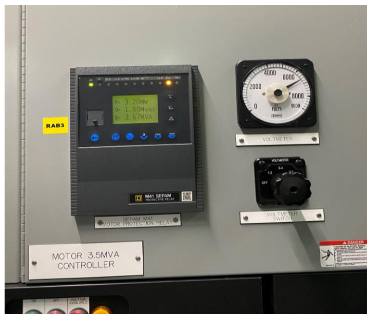
Figura 21. Relé de protección antebomba. Fuente: Elaboración propia. Fotografía tomada en visita a la planta.
