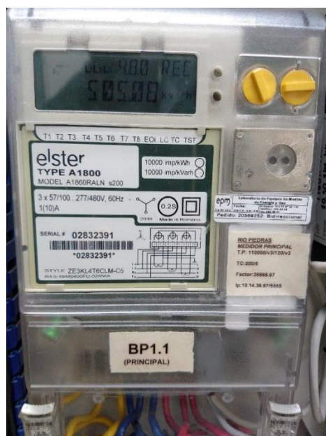
Figura 19. Medidor principal planta Rio Piedras consumo total de los 3 grupos. Fuente: Elaboración propia. Fotografía tomada en visita a la planta.
