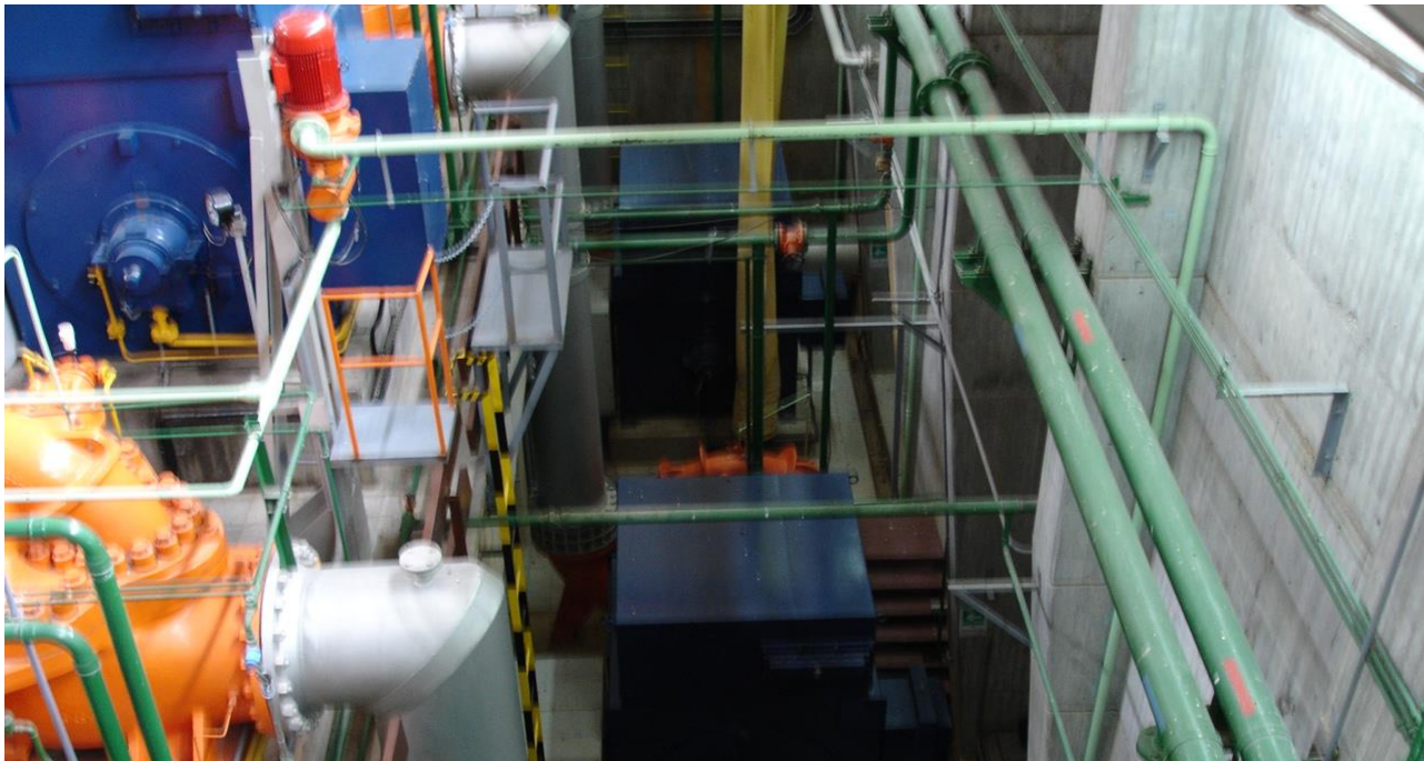
Figura 16. Vista superior antebomba. Fuente: Elaboración propia. Fotografía tomada en visita a la planta.
