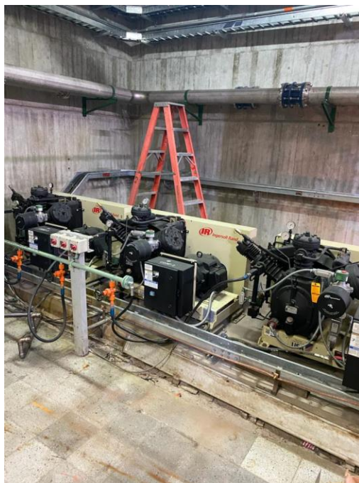
Figura 7. Compresores de los tanques hidroneumáticos.
