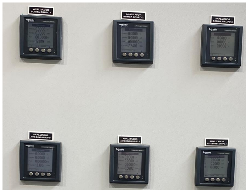
Figura 24. Analizador de red principal
