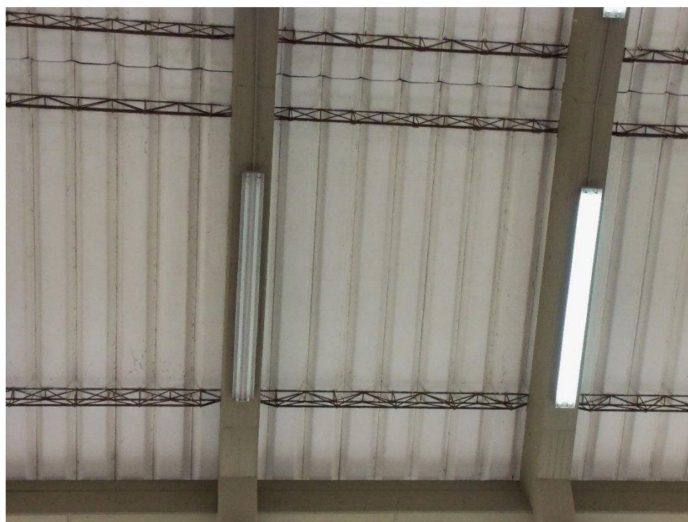
Figura 26. Lámpara mala, sala de máquinas.
