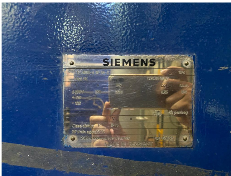
Figura 18. Datos de placa planta Rio Piedras Ante-Bomba Grupo 2 Fuente: Elaboración propia. Fotografía tomada en visita a la planta.
