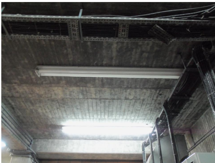
Figura 28. Lampara mala, cuarto de control ccm Fuente: Elaboración propia. Nota: Fotografía tomada en visita a la planta.
