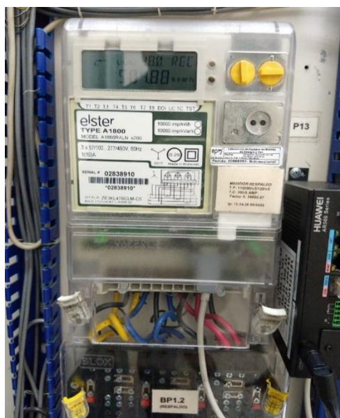
Figura 20. Medidor de respaldo planta Rio Piedras. Fuente: Elaboración propia. Fotografía tomada en visita a la planta.
