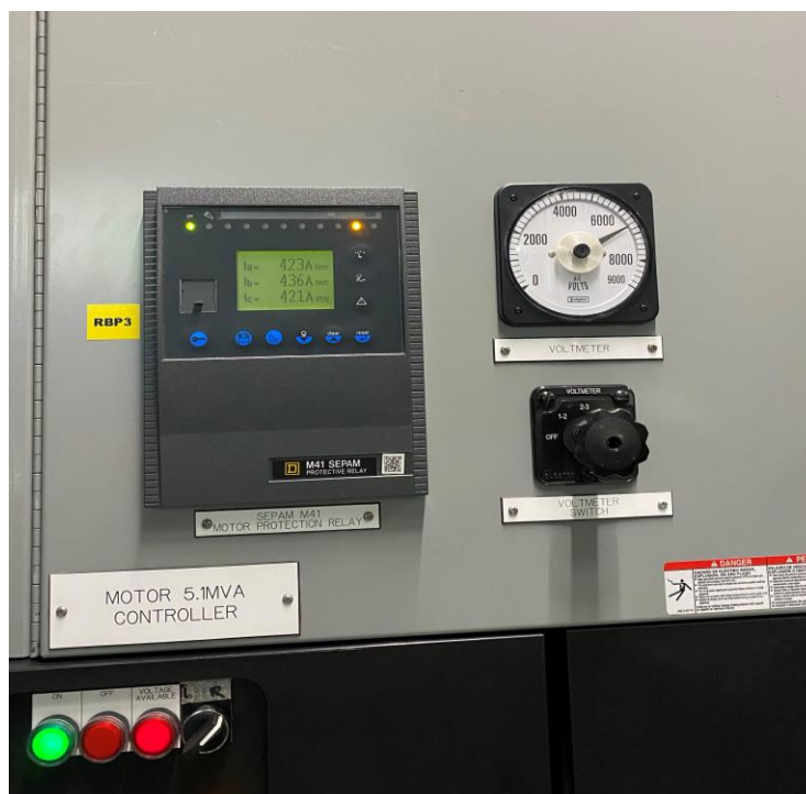
Figura 20. Relé de protección bomba principal Fuente: Elaboración propia. Fotografía tomada en visita a la planta.
