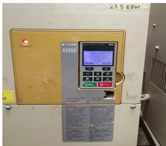
Figura 8. Tablero de control variador de frecuencia Yaskawa
