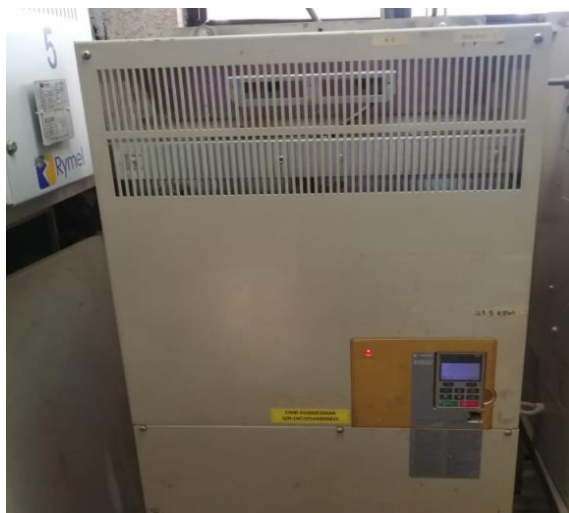
Figura 7. Estructura exterior variador de frecuencia Yaskawa
