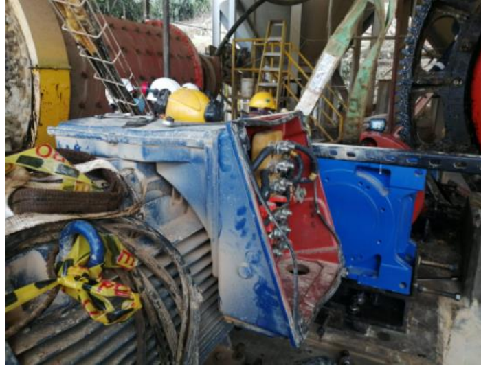
Figura 5. Caja de conexión molino de piedra
