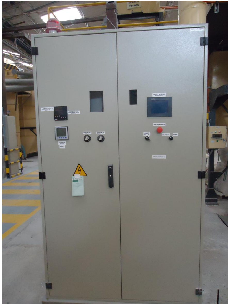
Foto 5. Presentación del tablero eléctrico del molino Anivi número tres.
