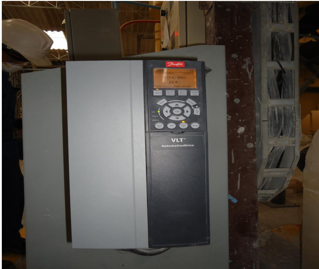
Foto 3. Variador de velocidad expuesto a la intemperie.
