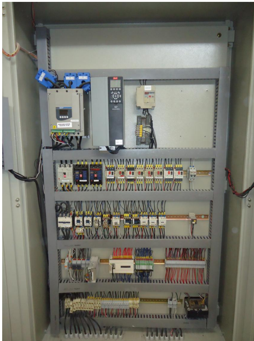
Foto 4. Distribución interna del tablero eléctrico.
