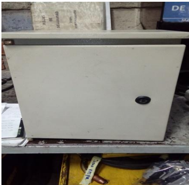
Figura 6. Gabinete eléctrico Fuente. Propia
