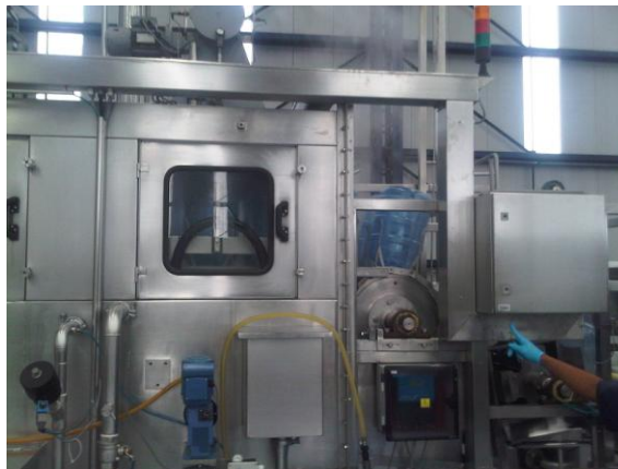
Figura 1. Entrada lavadora de botellón
