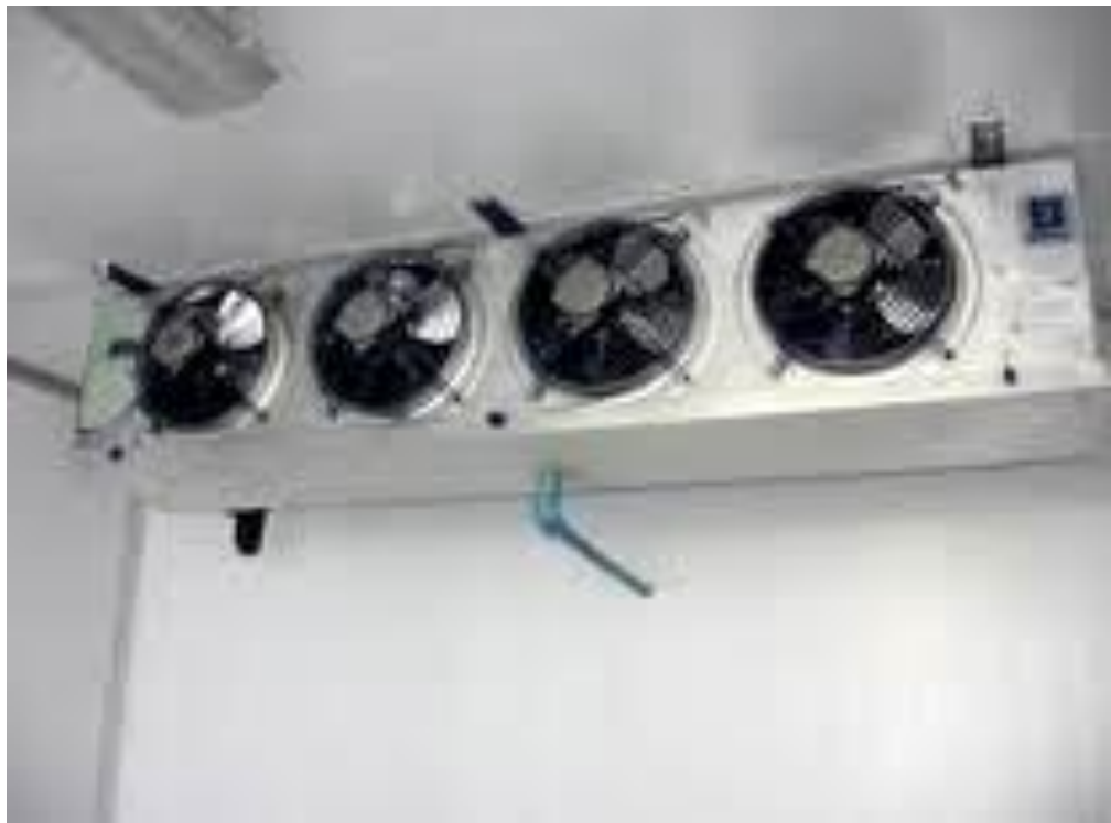
Figura 4. Ventilación en cámara de conservación
