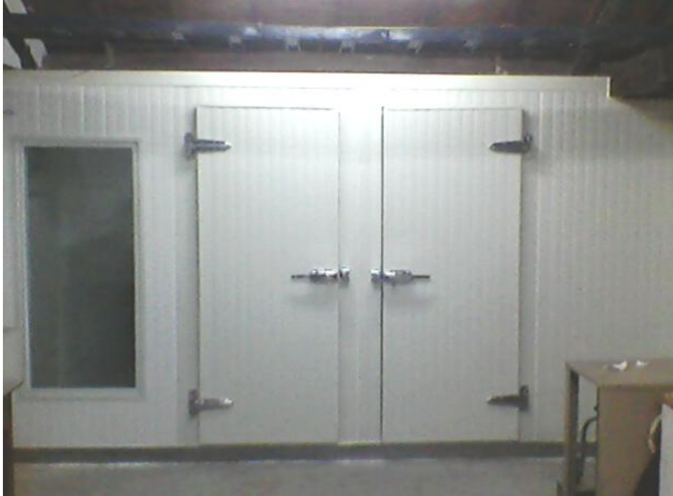
Figura 8. Cuarto de refrigeración, congelación y maduración
