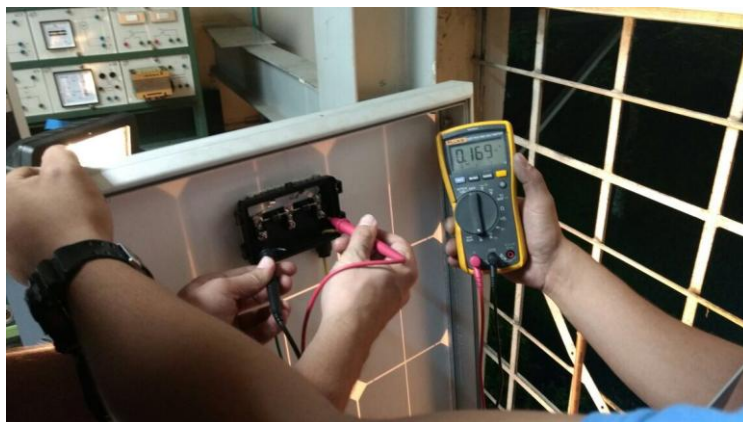
Figura 33. Corriente de corto circuito del panel solar. Fuente: imagen propia.
