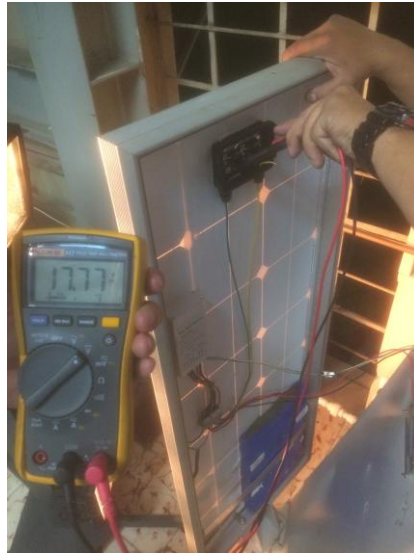
Figura 32. Voltaje en circuito abierto del panel solar. Fuente: imagen propia.
