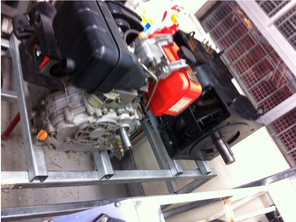
Figura 19 Eje del motor diésel y del generador alineados (Fotografía propia)
