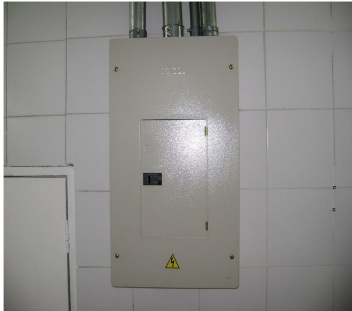
Figura 7. Sistema de alimentación de energía maquinas Saturno
