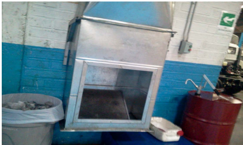
Figura 12. Extractores de humo
