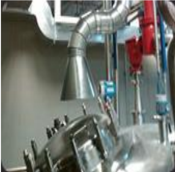
Foto 13 tuberías y montajes de aire industrial
