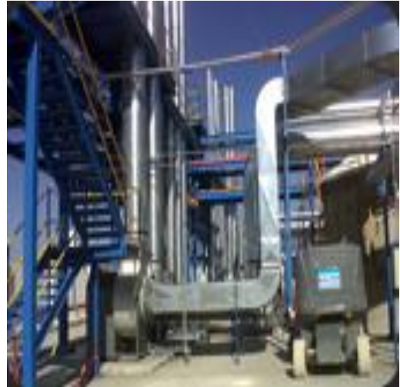
Foto 14. tuberías y montajes de aire industrial
