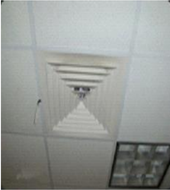
Foto 5. Rejilla de inyección aire acondicionado.
