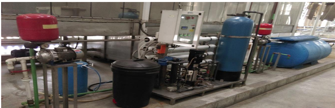
(Zapata, 2018) Fotos tomadas en planta 1 refrigeración.
