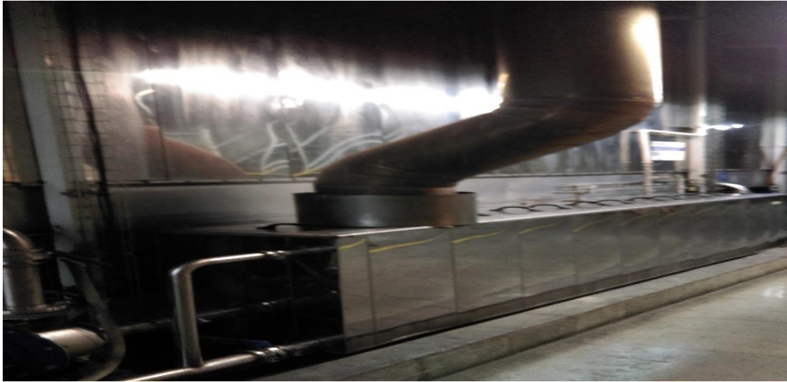
Ilustración 29 Chimenea para vapor tanque 2
