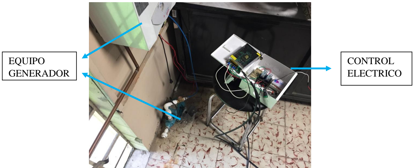
Figura 16: Control eléctrico y equipo. Fuente: propia
