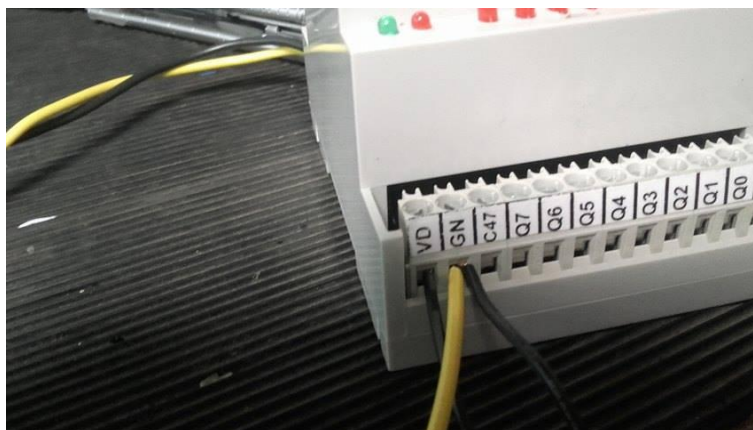
Figura 13: Conexión del automático a la fuente de voltaje y señal de prueba.
