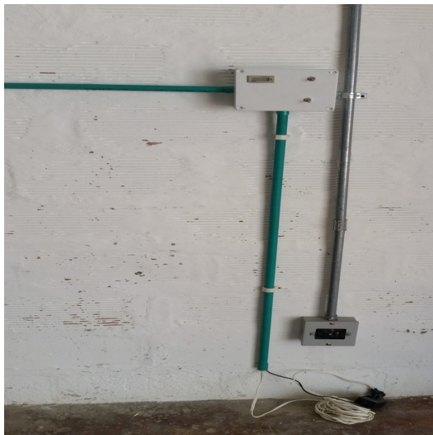
Figura 14. Contador instalado en la pared con el cableado
