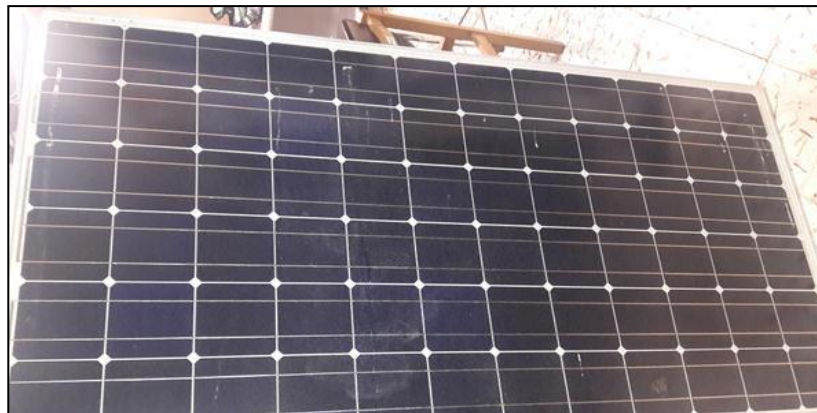
Figura 6. Vista frontal panel solar Fuente:(Propia)
