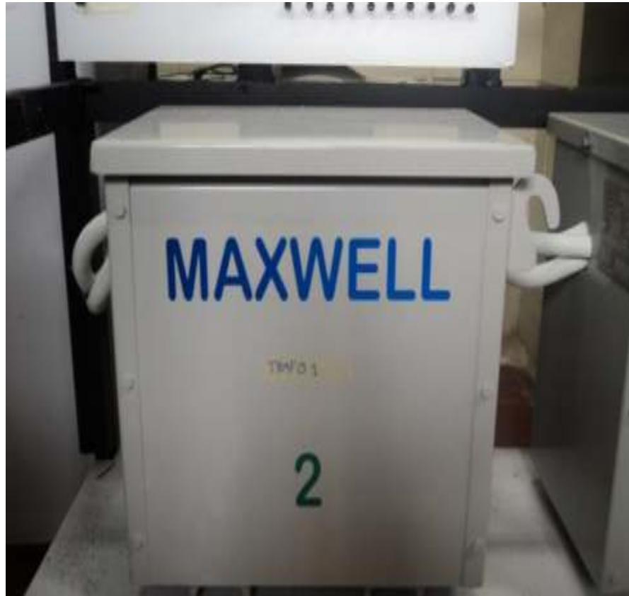
Gráfico 14. Transformador de de 2kva del módulo
