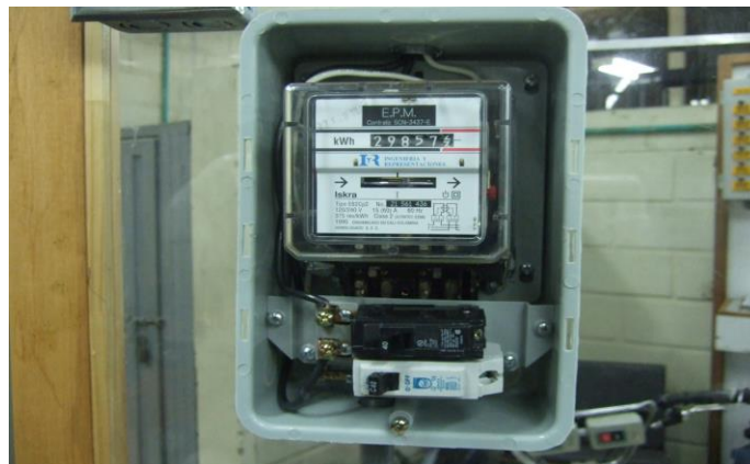
Figura 27. Medidor de energía en el modulo didáctico de instalaciones eléctricas domiciliarias.
