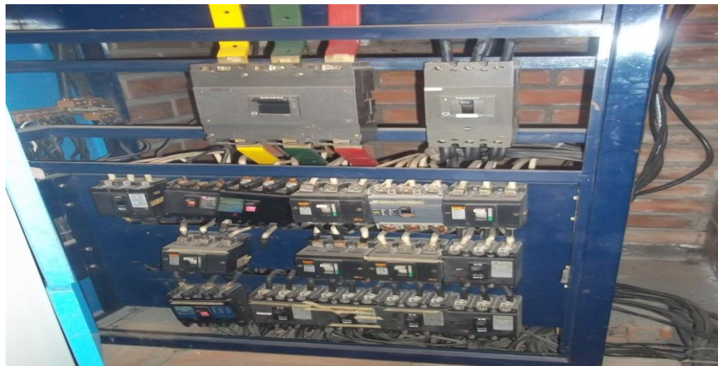
Figura 2 Subestación de la Institución Universitaria Pascual Bravo
