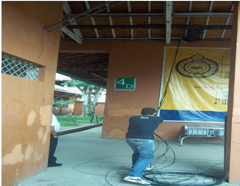
Figura 10 Cable de acometida saliendo al pasillo de los bloques 4C y 4D
