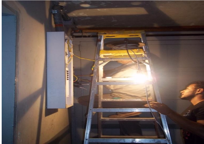
Figura 13 Conexiones en el taller de eléctrica bloque 4C
