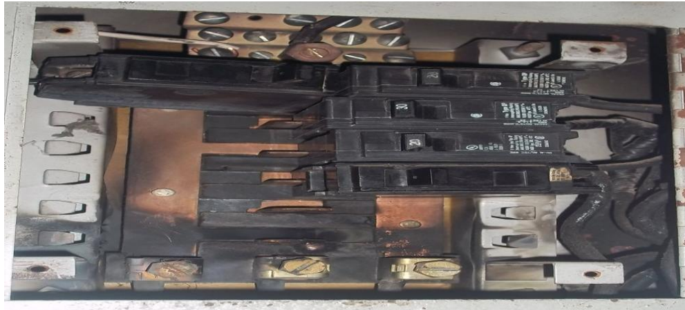
Figura 1 Tablero de distribución antiguo
