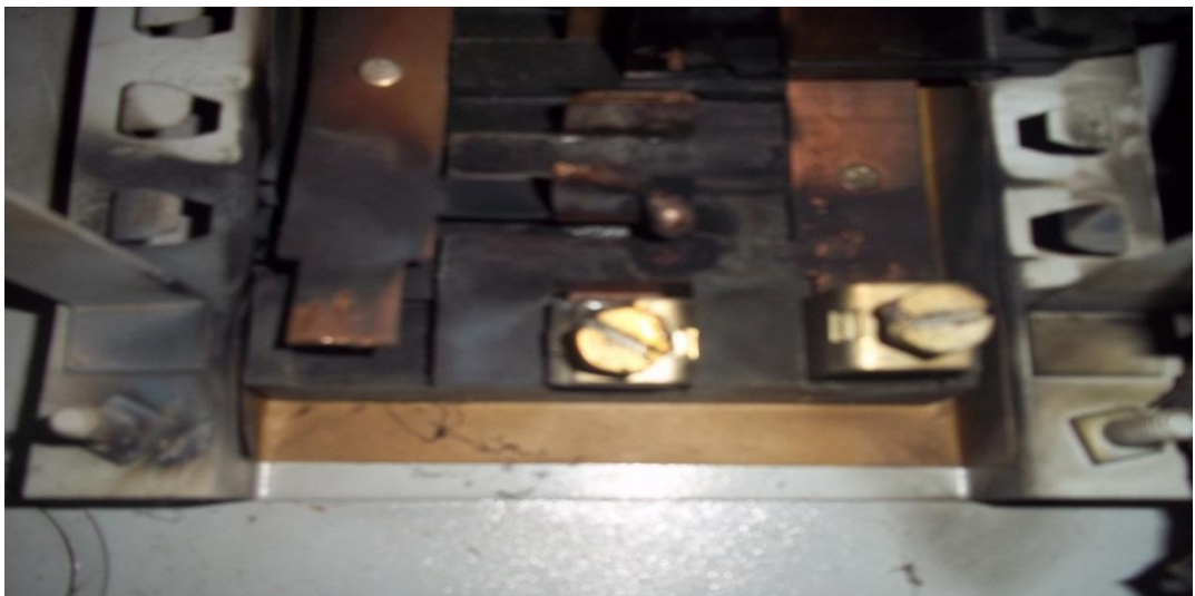
Figura 4 Barraje del tablero de distribución en corto circuito
