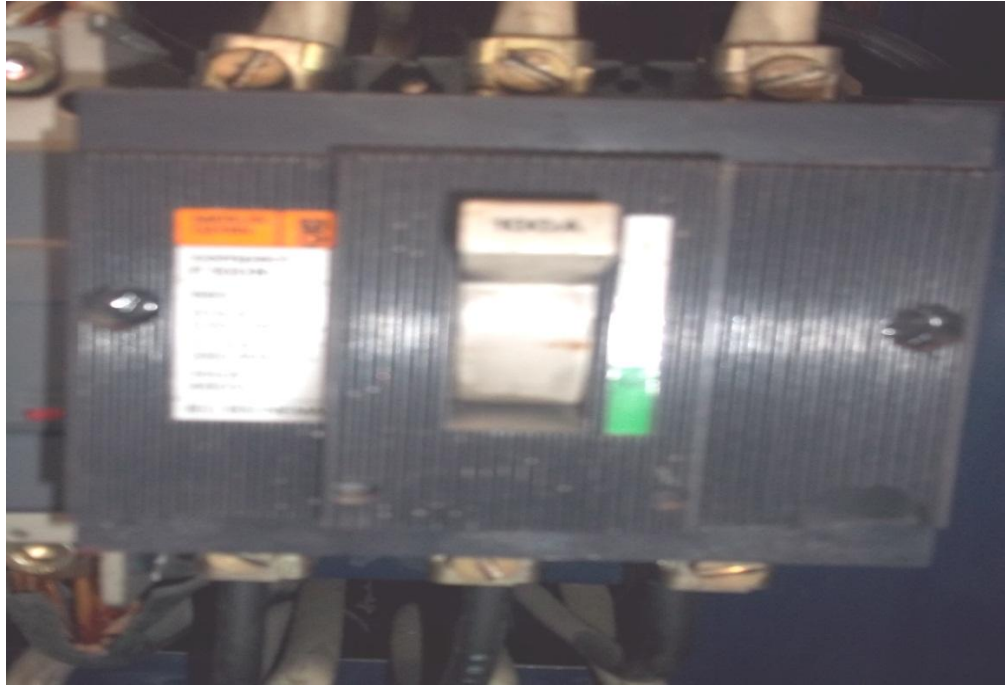
Figura 3. Breaker de protección del taller de eléctrica
