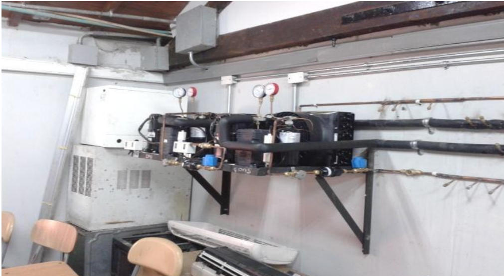
Fuente: ARBOLEDA García Milton Vladimir. Laboratorio de refrigeración y aire acondicionado del IUPB Fotografía. 2013
