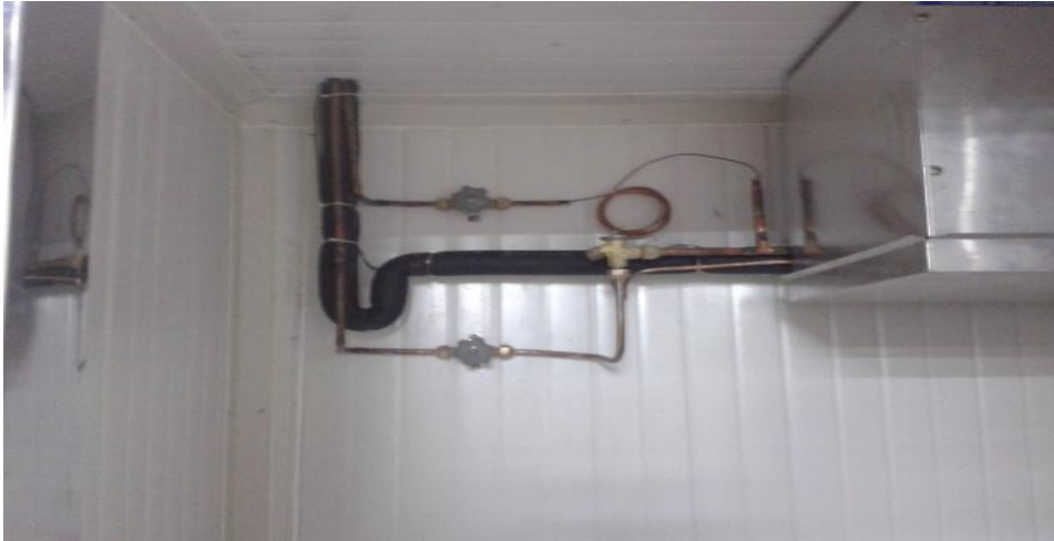
Fuente: ARBOLEDA García Milton Vladimir. Laboratorio de refrigeración y aire acondicionado del IUPB Fotografía. 2013
