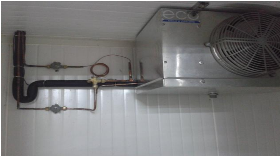
Figura 23 Tubería, válvulas de expansión y ventiladores de la unidad condensadora para la conservación de alimentos.
