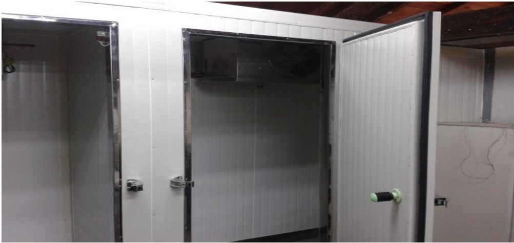
Figura 22 Cavas de la unidad condensadora para la conservación de alimentos.
