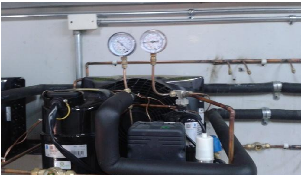
Fuente: ARBOLEDA García Milton Vladimir. Laboratorio de refrigeración y aire acondicionado del IUPB Fotografía. 2013
