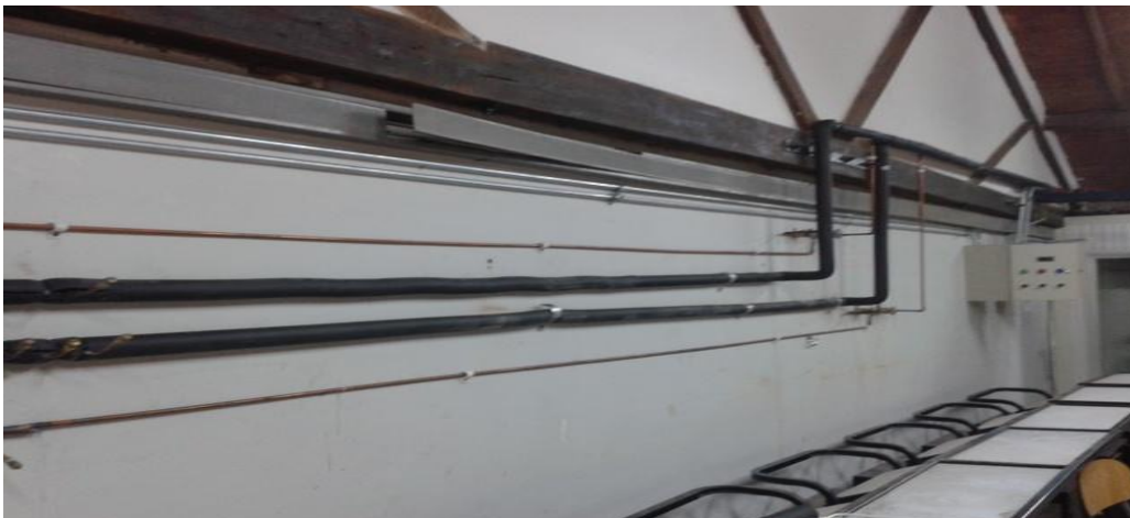
Fuente: ARBOLEDA García Milton Vladimir. Laboratorio de refrigeración y aire acondicionado del IUPB Fotografía. 2013
