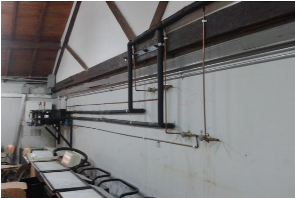
Fuente: ARBOLEDA García Milton Vladimir. Laboratorio de refrigeración y aire acondicionado del IUPB Fotografía. 2013
