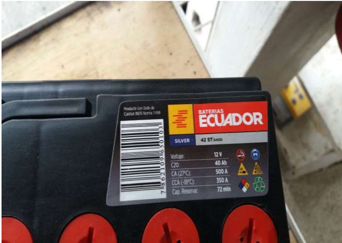
Figura 19 Datos de placa Batería Hydraulan Fuente. Propia
