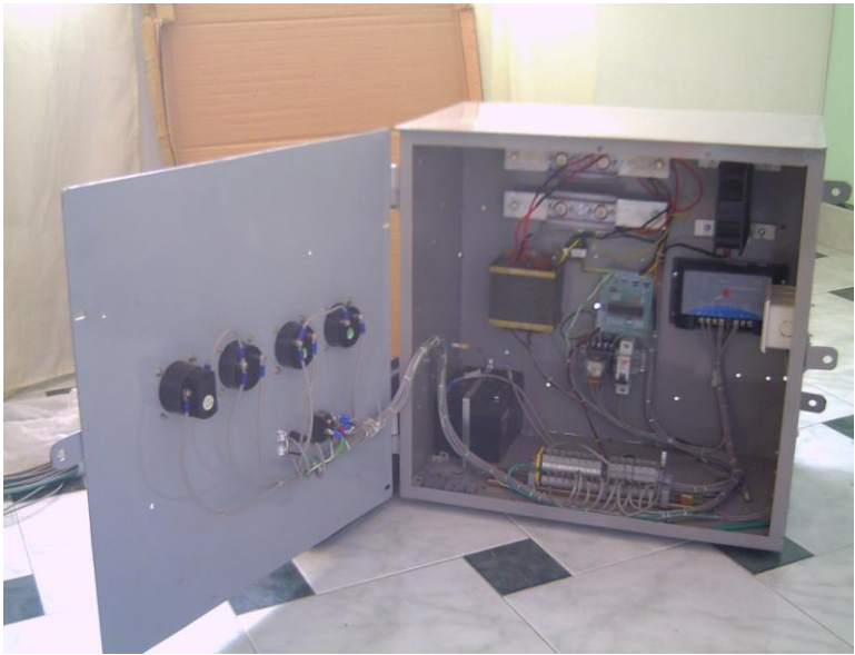
Figura 20. Vista interna del panel solar didáctico completa
