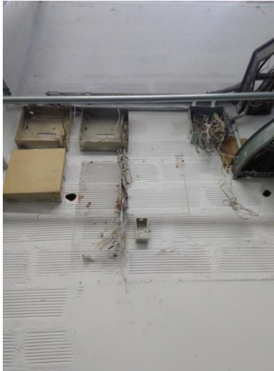
Ilustración 14. Cables eléctricos sueltos.
