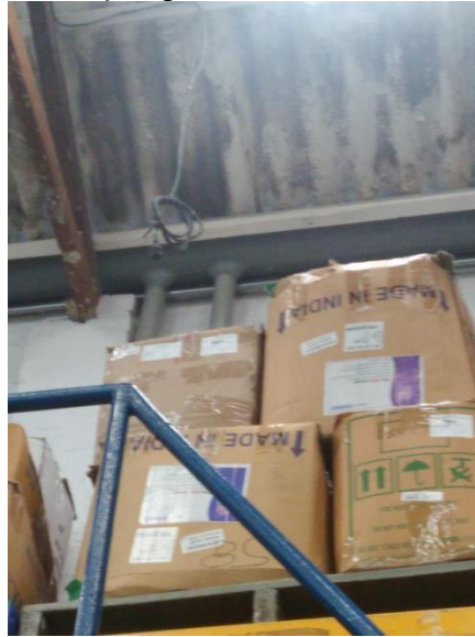
Ilustración 18. Cables eléctricos peligrosos.
