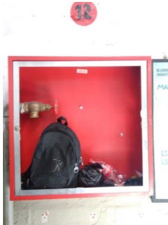
Ilustración 13. Manguera contra incendios.
