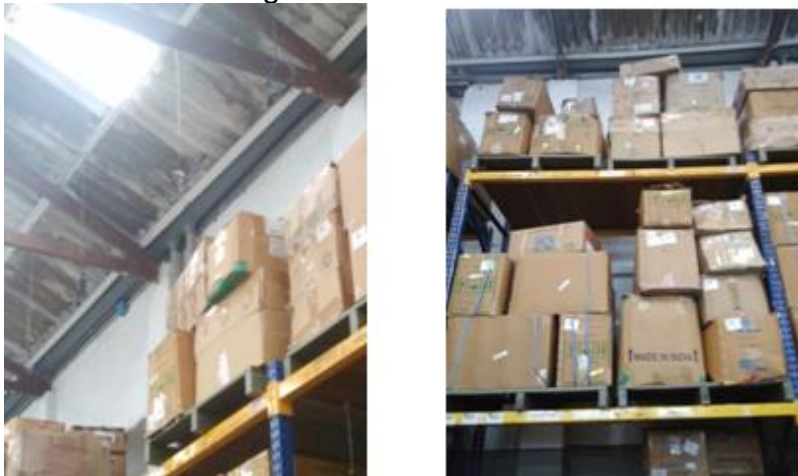
Ilustración 17. Peligro de caída
