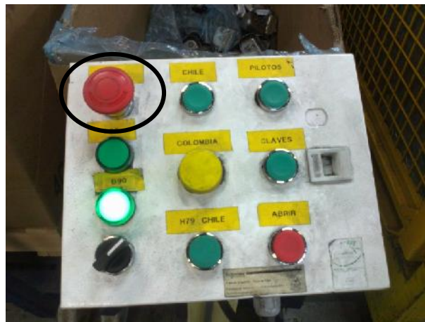
Figura 24 - Panel de control (Paro de emergencia)
