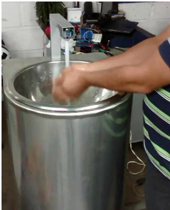
Figura 21 Lavamanos con sensor activado
