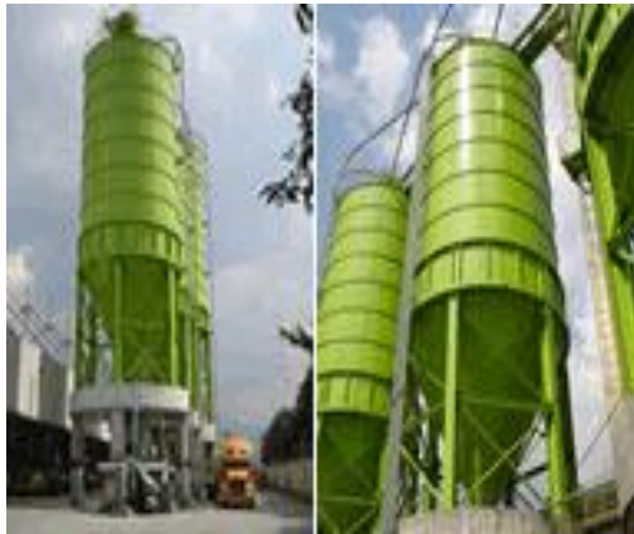
Imagen 11. Silos para Almacenamiento de Cemento
