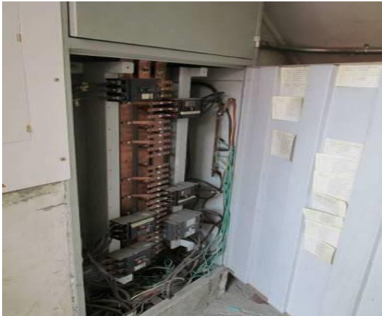
Fotografía 42. Disposición del tablero Principal Bloque 5
