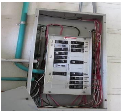
Fotografía 32. Disposición del tablero Principal Bloque 4D
