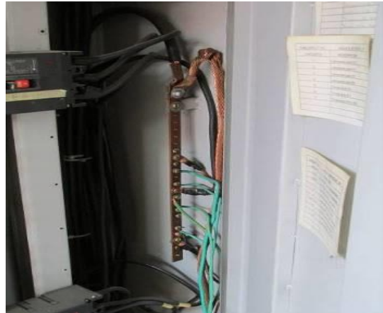
Fotografía 43. Barra de Tierra del Bloque 5
