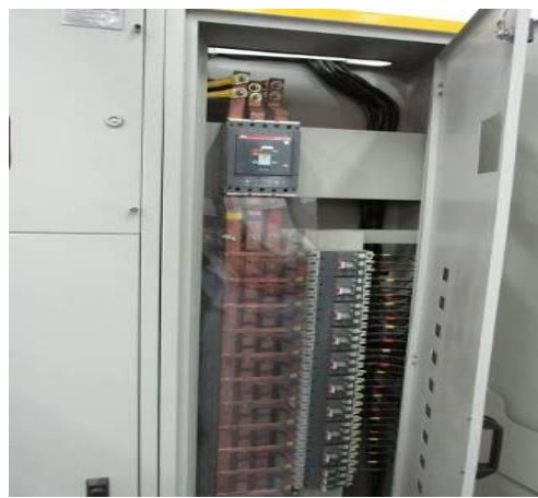
Fotografía 41. Conexión del tablero del Bloque 4M
