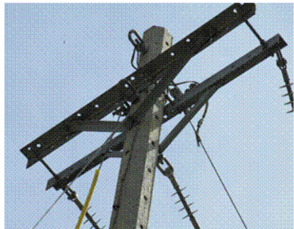
Fotografía 4. Circuito de media tensión Bloque 9
