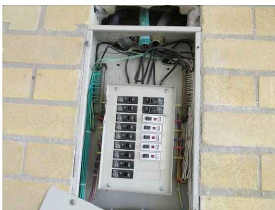
Fotografía 50. Disposición del tablero regulado 01, piso1
