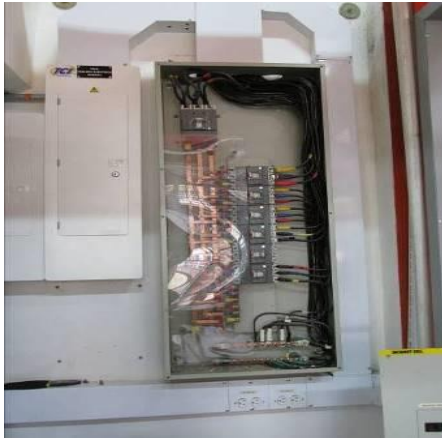
Fotografía 34. Disposición del tablero Principal Bloque 4E
