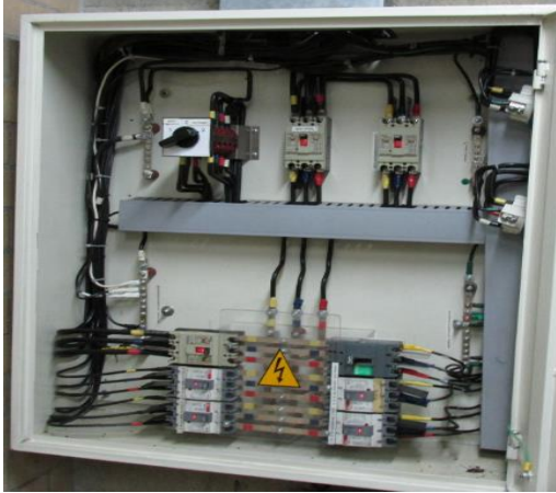
Fotografía 64. Disposición del tablero Regulado SE Bloque 9
