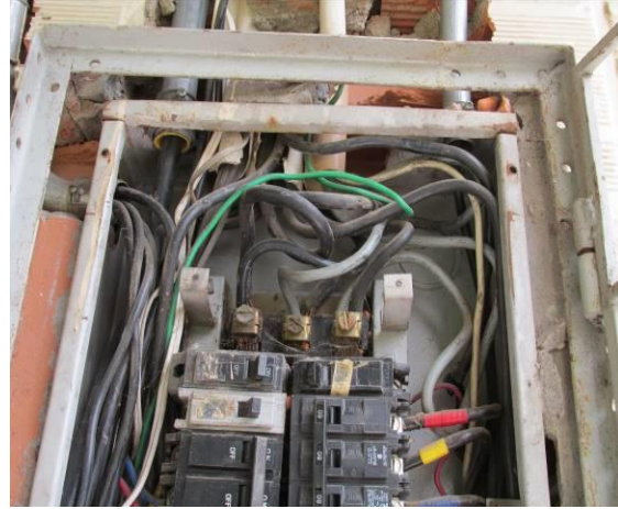
Fotografía 23. Barra de tierra y neutro del Bloque 3A, Aula 107
