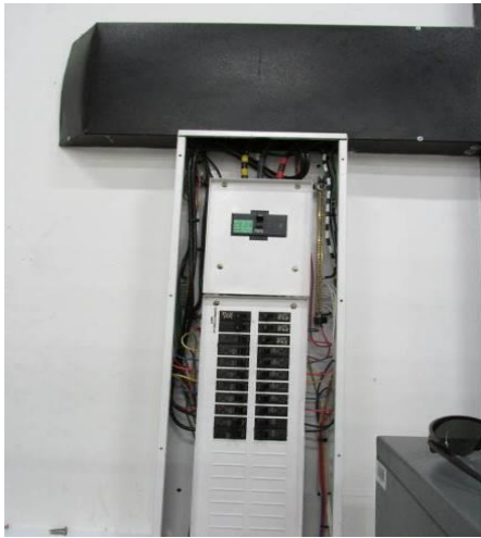
Fotografía 36. Disposición del tablero Principal Bloque 4G
