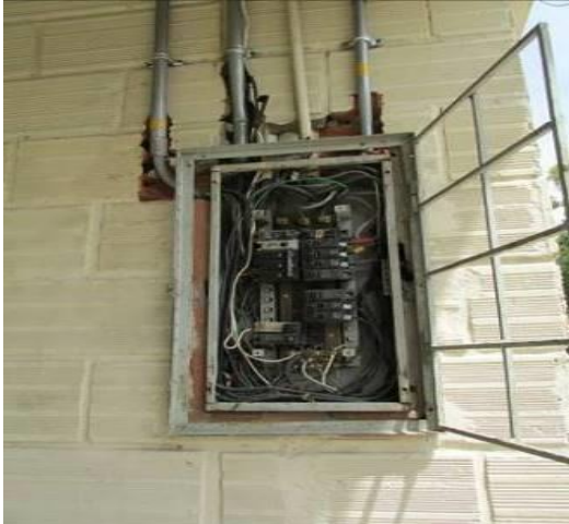
Fotografía 22. Disposición del tablero Principal Bloque 3A, Aula 107
