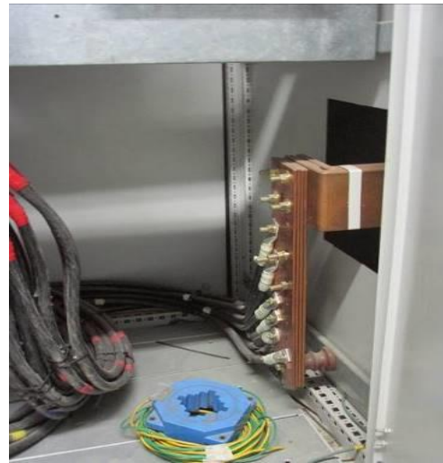
Fotografía 25. Subestación Bloque 3B
