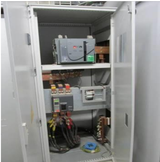
Fotografía 24. Subestación Bloque 3B
