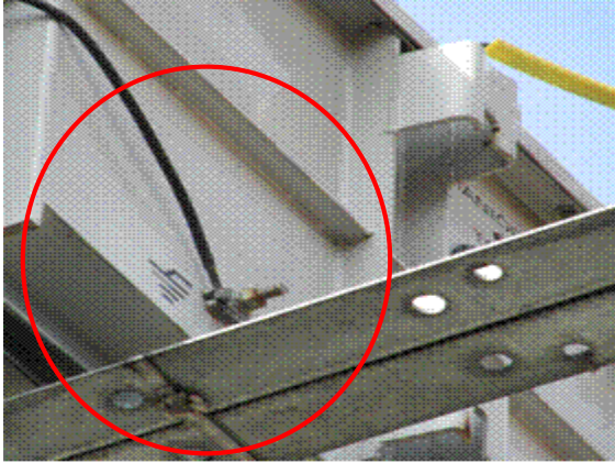
Fotografía 12. Puesta a tierra del transformador Bloque M
