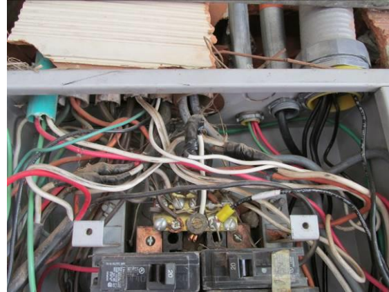
Fotografía 21. Barra de tierra y neutro del Bloque 3A, Aula 106
