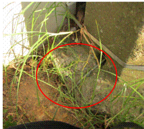
Fotografía 9. Conexión entre conductor de tierra y electrodo del transformador de la cancha
