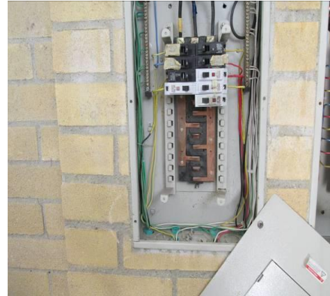
Fotografía 49. Barra de tierra del tablero iluminación TB2, piso 1
