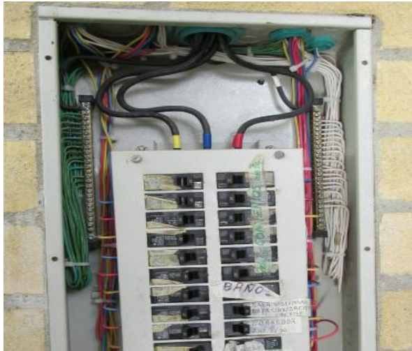
Fotografía 56. Disposición del tablero 01 iluminación
