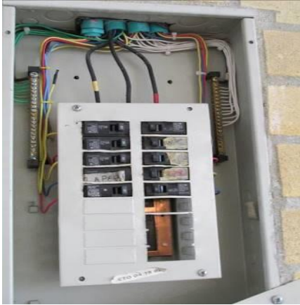
Fotografía 54. Disposición del tablero 04 TR02, piso 1
