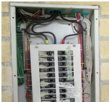
Fotografía 58. Disposición del tablero 02 iluminación
