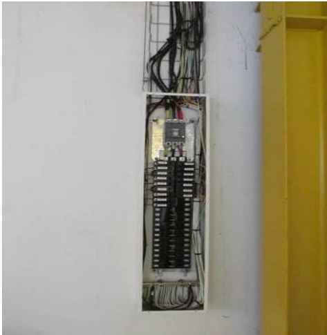
Fotografía 30. Disposición del tablero Principal Bloque 4C
