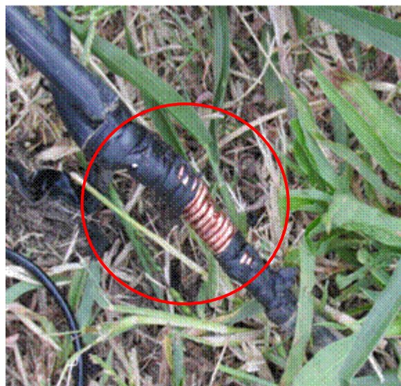
Fotografía 11. Entorche entre conductores de tierra
