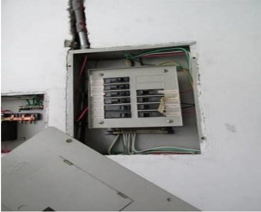
Fotografía 26. Disposición del tablero Principal Bloque 3C
