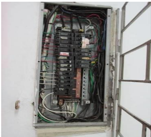
Fotografía 16. Disposición del tablero Principal Bloque 2, piso 1
