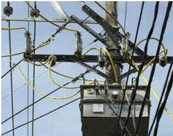
Fotografía 3. Transformador de iluminación de la cancha de fútbol
