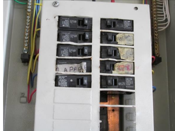
Fotografía 55. Conexionado del tablero 04 TR02, piso 1
