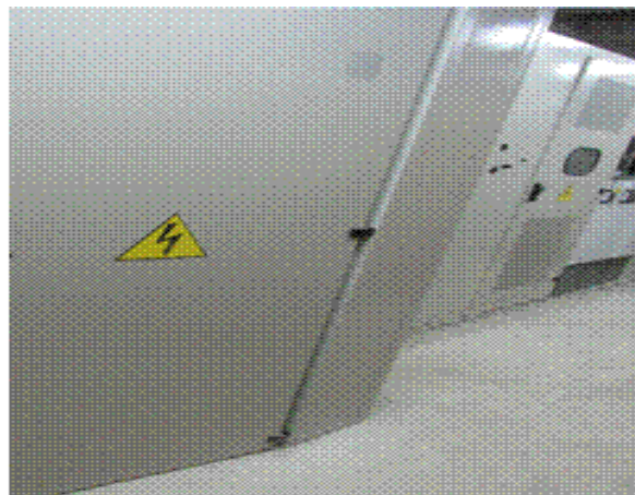
Fotografía 67. Señalización de seguridad subestación Bloque 9
