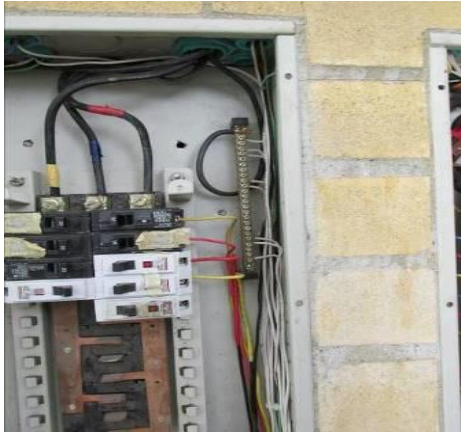
Fotografía 48. Disposición del tablero iluminación TB2, piso 1
