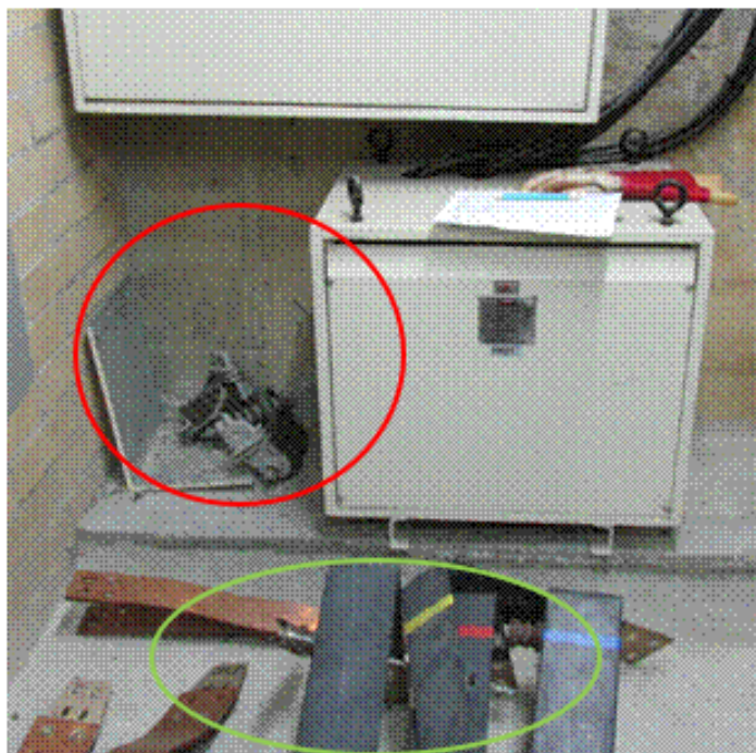
Fotografía 68. Elementos de obstrucción en la subestación bloque 9
