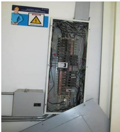
Fotografía 38. Disposición del tablero Principal Bloque 4J
