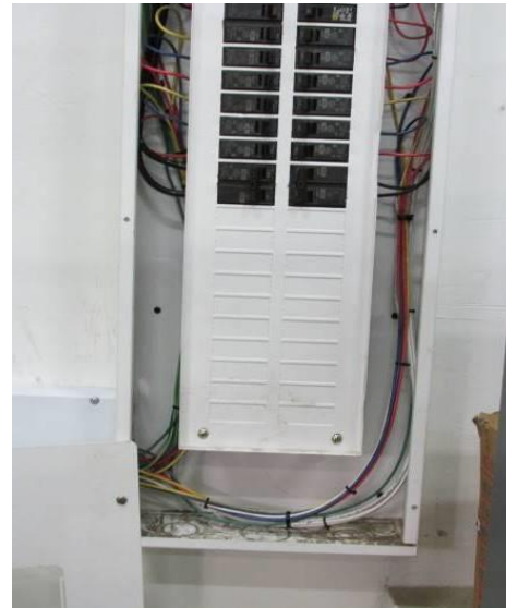
Fotografía 37. Conexión del tablero del Bloque 4G
