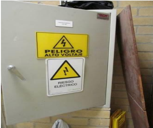
Fotografía 46. Disposición del tablero Principal Bloque 7
