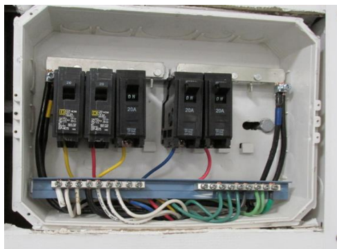
Fotografía 60. Disposición del tablero T.E.I
