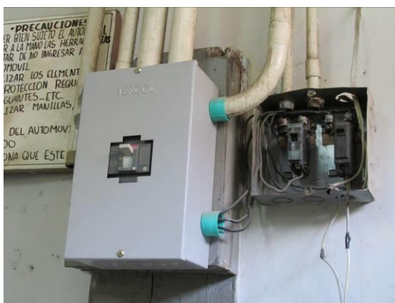
Fotografía 28. Disposición del tablero Principal Bloque 4ª
