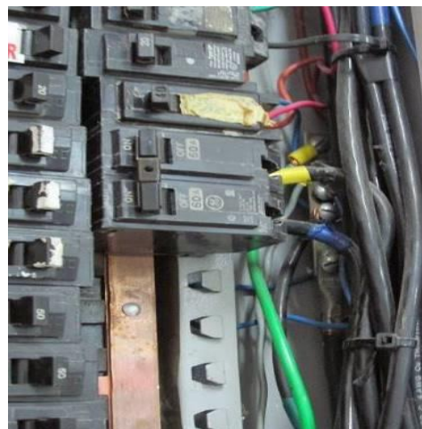
Fotografía 17. Barra de tierra del Tablero Bloque 2, , piso 1
