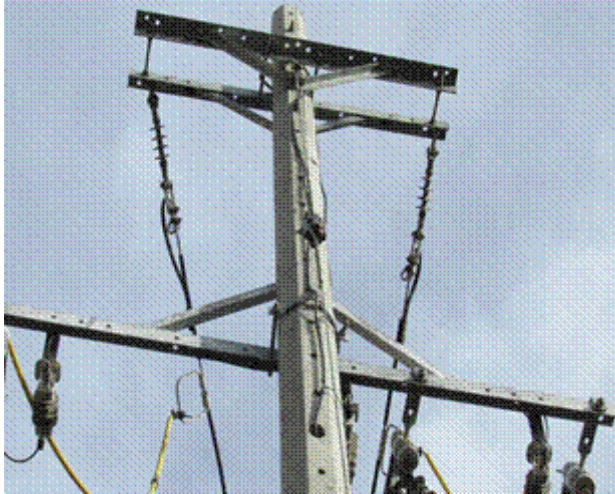
Fotografía 1. Circuito de media tensión Bloque 3B
