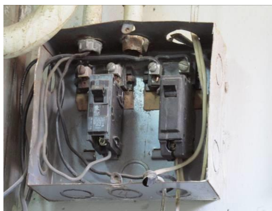
Fotografía 29. Conexionado del tablero del Bloque 4ª
