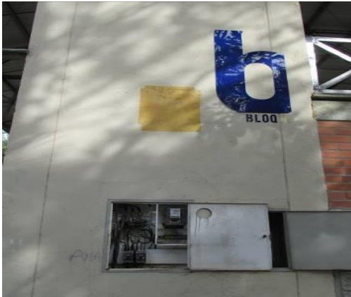
Fotografía 44. Disposición del tablero Principal Bloque 6
