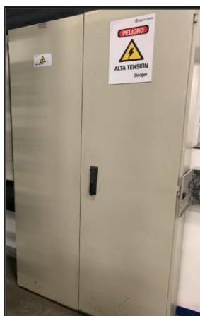
Figura 12. M.L T.S Taller de soldadura - 220V, 3 \Phi , 200 A Fuente. Fotografía propia
