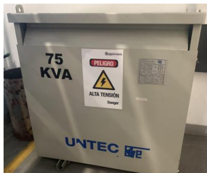
Figura 10. Transformador 3 \Phi seco abierto de 75 kVA Fuente. Fotografía propia
