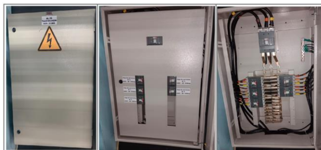
Figura 11. M.L T.S Taller de soldadura - 440V, 3 \Phi , 200 A Fuente. Fotografía propia
