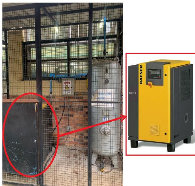
Figura 14. Ubicación del compresor de tornillo KAESER
