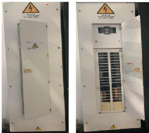
Figura 13. T.E.N.T.S Tablero de circuitos (taller de soldadura) - 220V, 3 \Phi , 100 A Fuente. Fotografía propia
