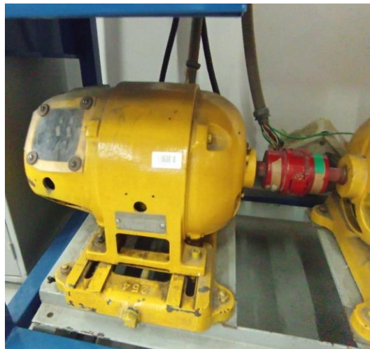
Foto 4 Motor generador sincrónico con armadura en el estator, conexiones expuestas y sucio
