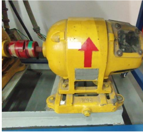
Foto 5 motor de inducción trifásico con rotor devanado, placa no visible, ni legible
