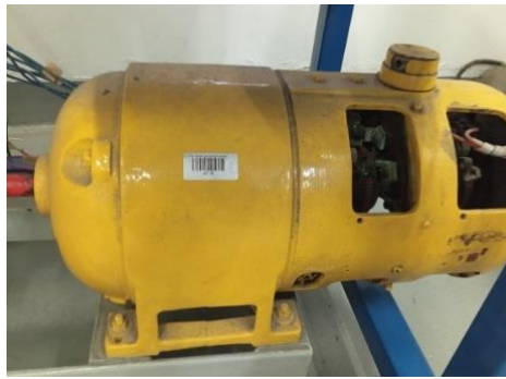
Foto 31 Motor de inducción Schrage borneras expuestas
