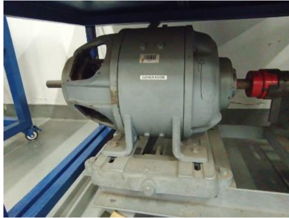
Foto 27 Motor generador DC sin placa
