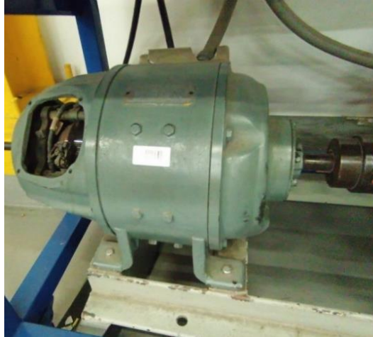
Foto 12 Motor generador DC, sin ficha técnica.
