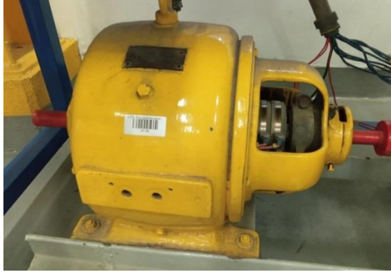
Foto 30 Motor generador sincrónico con armadura en el rotor
