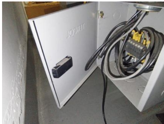
Foto 28 Caja con cables abierta y sucia
