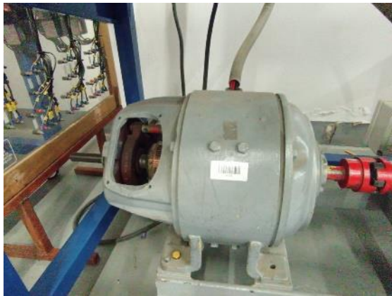
Foto 24 Motor generador DC sin placa que contenga su información
