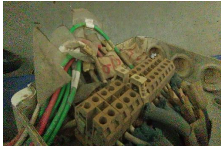
Foto 7 cables expuestos, caja sin tapa y muy sucia (riesgo eléctrico)
