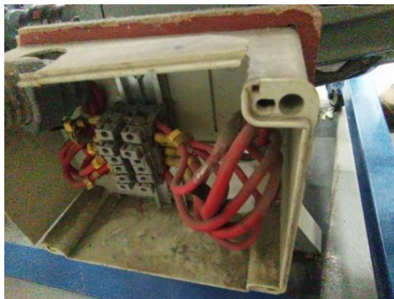
Foto 14 Caja sin tapa, contactos expuestos.
