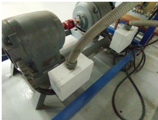
Foto 23 Caja y cables expuestos
