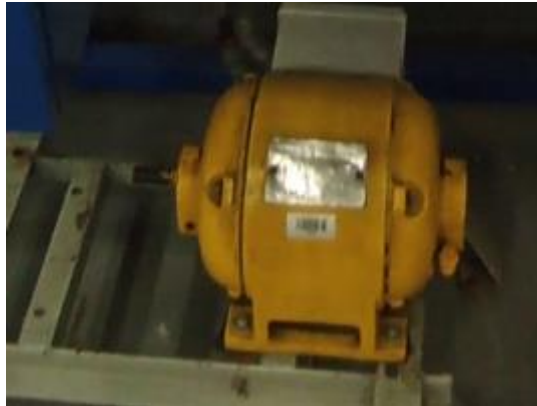
Foto 2 Motor de inducción trifásica con placa en mal estado
