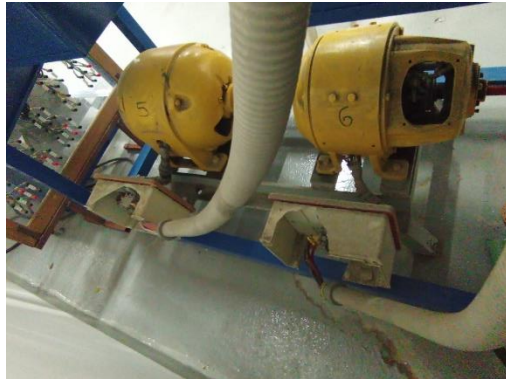
Foto 20 Motores sin placa, sin tapas en las conexiones
