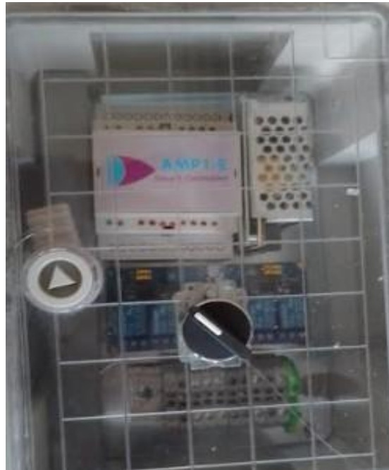
Figura 11 tablero de control de la empacadora
