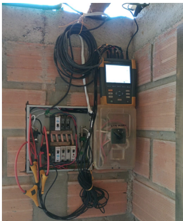
Figura 18. Medición con analizador de redes.
