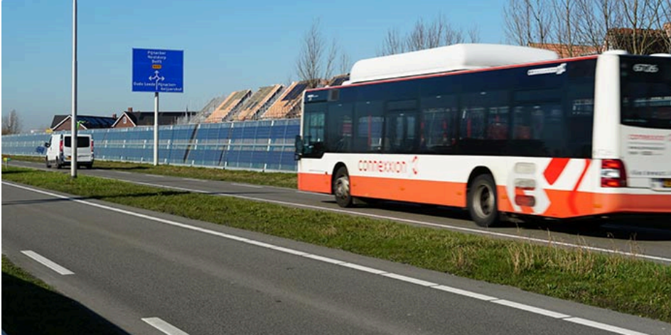
Figura 7. Barreras Acústicas Fotovoltaicas.
