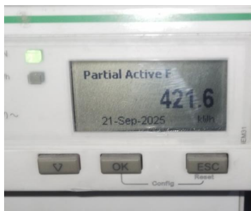
Figura 18. Lectura 3 medidor Schneider 24/09/2025 Fuente. Tomada de la empresa Vajillas Corona
