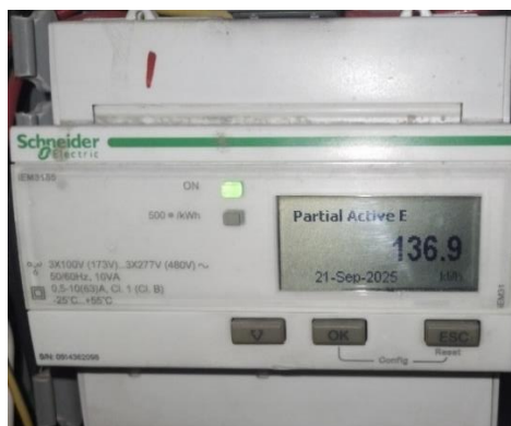
Figura 16. Lectura 1 medidor Schneider 22/09/2025 Fuente. Tomada de la empresa Vajillas Corona
