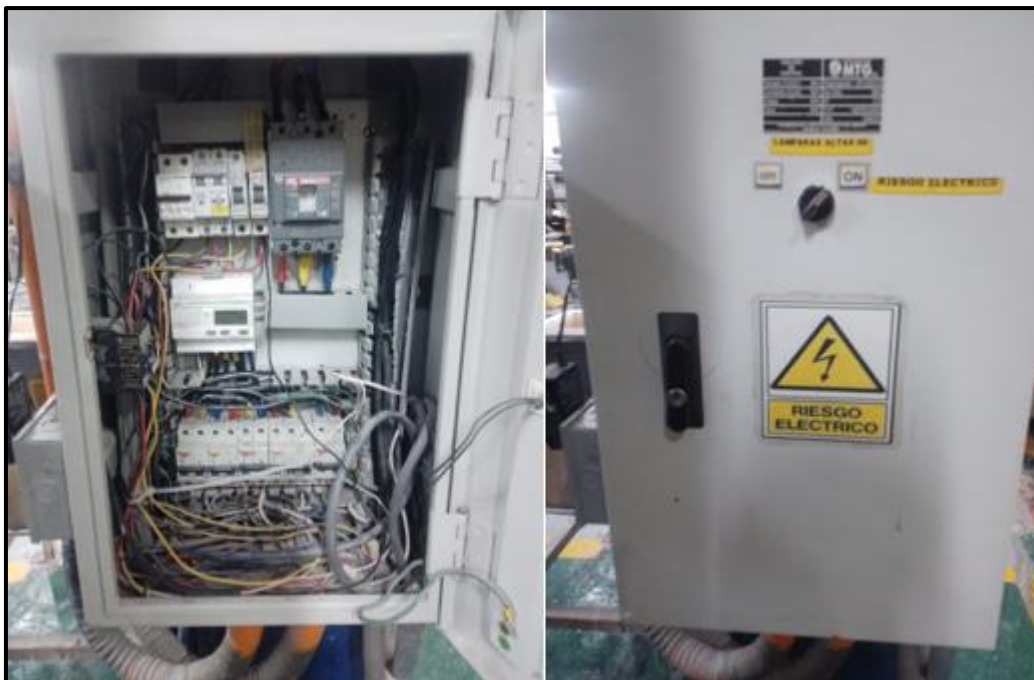
Figura 14. Tablero de distribución
