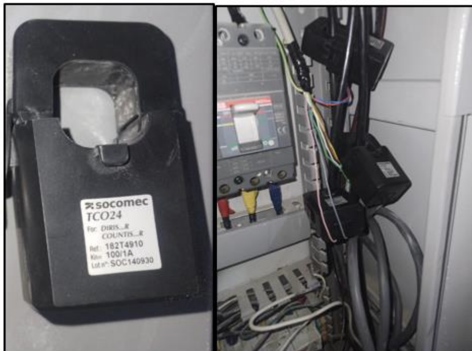
Figura 25. Transformadores de corriente Fuente. Tomada de la empresa Vajillas Corona
