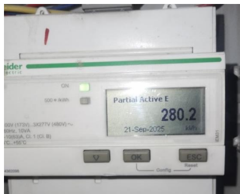
Figura 17. Lectura 2 medidor Schneider 23/09/2025 Fuente. Tomada de la empresa Vajillas Corona
