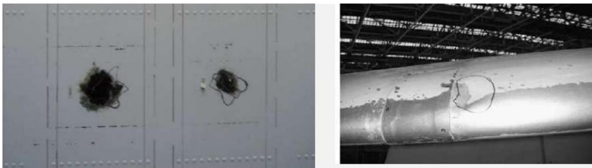
Ilustración 16. Ejemplos de daños por abolladuras e impactos de rayo.
