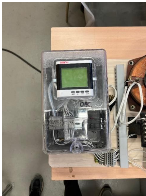
Figura 8. Tablero para auditoría energética Fuente. Propia
