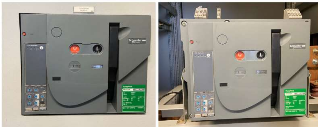
Figura 13. Totalizador principal. Fuente. propia.
