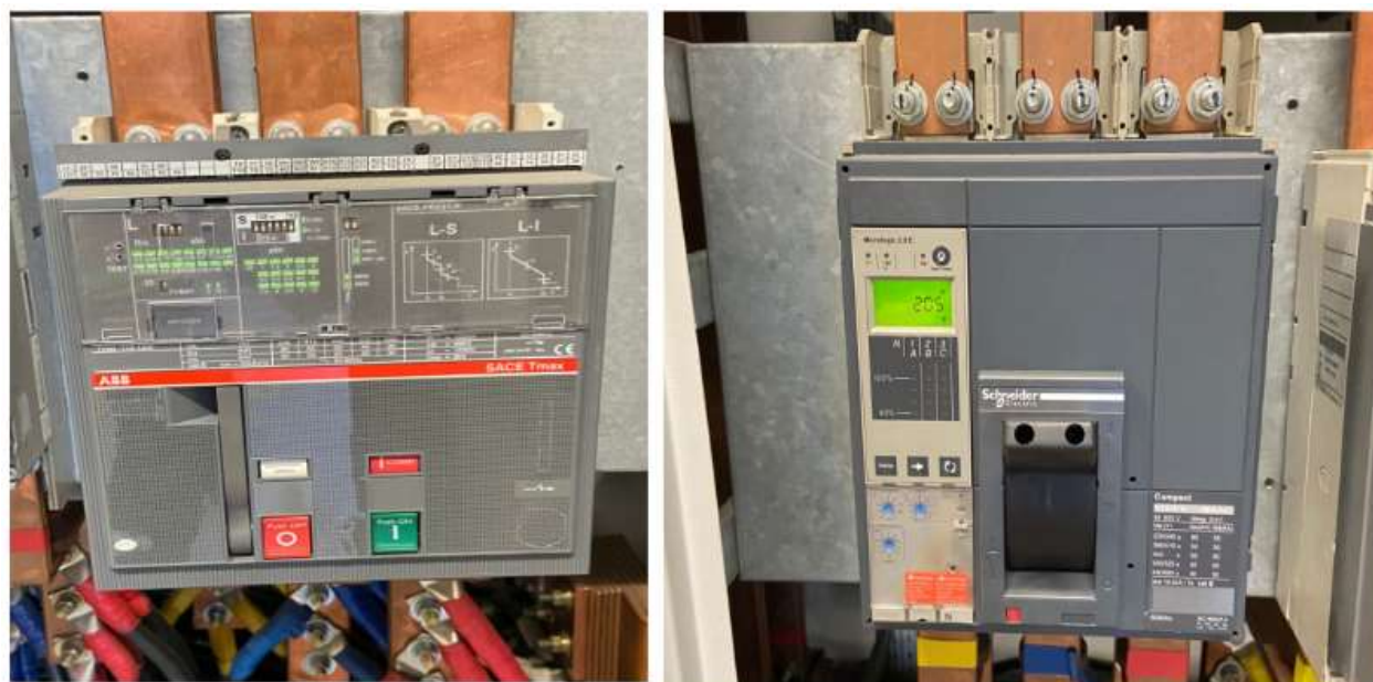
Figura 14. Totalizadores de distribución. Fuente. propia.
