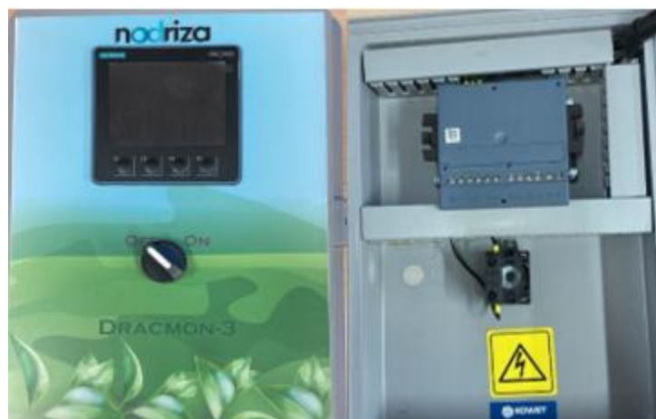
Figura 6: Medidor Siemens Pac3120 – lado frontal y trasero Fuente: diseño propio
