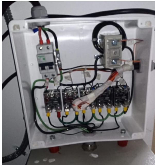
Figura 11 Relés de Estado Sólido y Transformador de Corriente Fuente: Imagen propia
