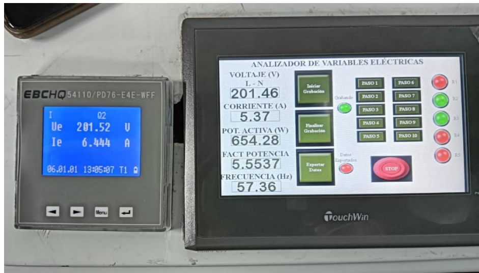
Figura 13 Analizador de Redes y HMI Fuente: Imagen propia
