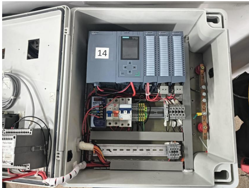
Figura 12 Tablero de Control del PLC Fuente: Imagen propia
