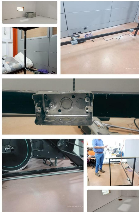
Ilustración 12. Proceso de Ensamble Físico: Detalle de la Perforación de la Mesa e Instalación de Tubería EMT y Cascos de Tomacorrientes.
