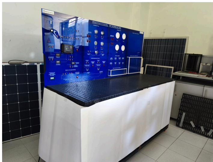
Figura 15. Módulo de pruebas con cerramiento para aislamiento lumínico y térmico.
