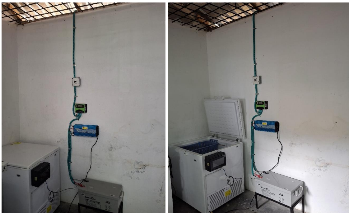
Ilustración 30: Instalación de interruptor, regulador de carga, batería, inversor de onda y congelador.
