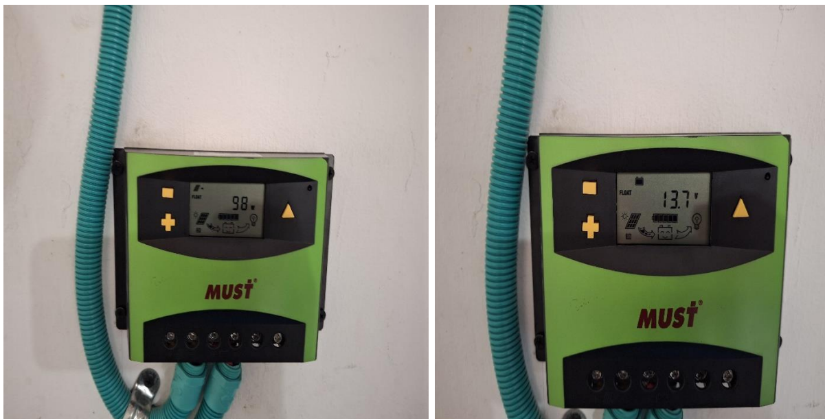
Ilustración 31: Puesta en servicio y pruebas de funcionamiento del sistema fotovoltaico con el refrigerador.
