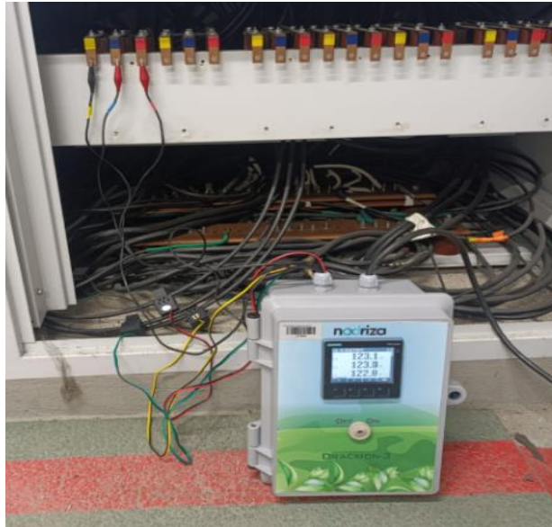
Figura 5. Resultado final de conexión del equipo de medida medidor multifuncional Fuente. Diseño Propio
