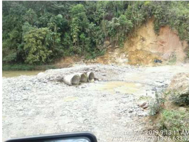
Fotografía 5 Punto crítico que requiere construcción de Box Couvert
