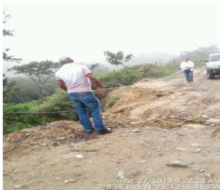
Fotografía 4 Punto crítico que requiere intervención con muro de contención
