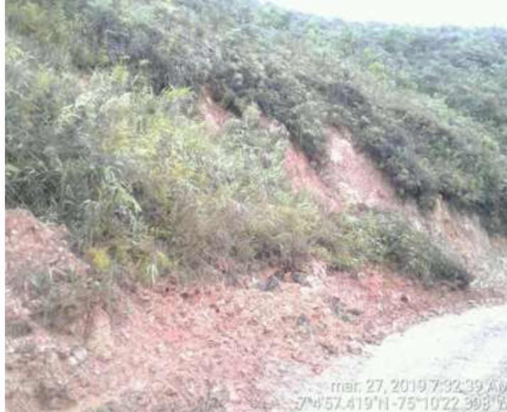
Fotografía 1 Derrumbes presentes en la vía
