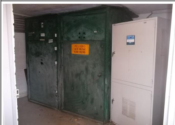
FOTO 6. SUBESTACIÓN NORTE 500Kva.
