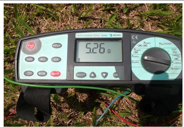
FOTO 3. REGISTRO DE UNA DE LAS 7 MEDIDAS REALIZADAS CON TELURHOMETRO METREL.
