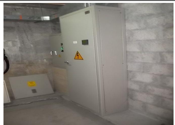
FOTO 5. M/L PRINCIPAL SUBESTACIÓN 300kVa CIS.
