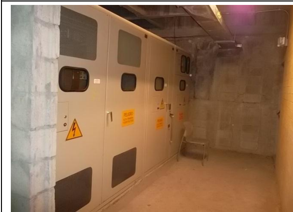
FOTO 4. SUBESTACIÓN 300kVa CIS.
