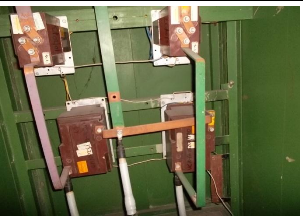
FOTO 7. CELDA DE MEDIDA FUERA DE SERVICIO.
