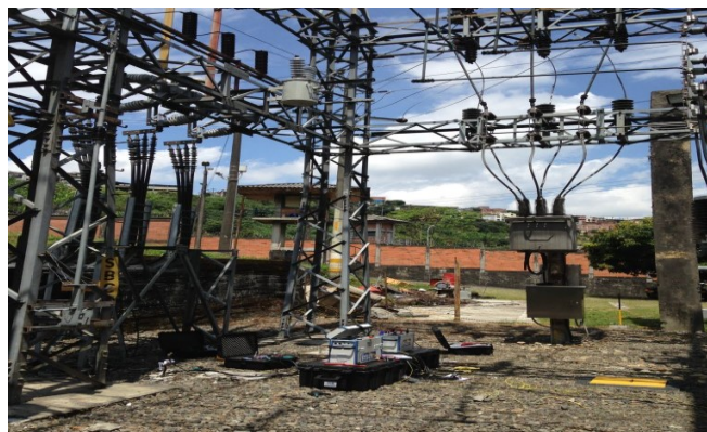
Figura 50. Pruebas en pararrayo y seccionadores
