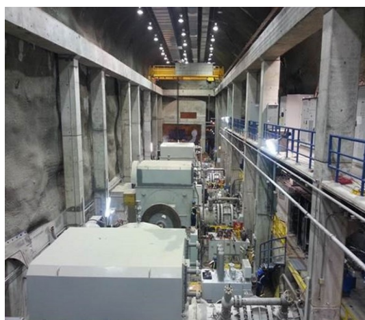
Figura 2 Central Hidroeléctrica BONYIC (EPM Panamá)
