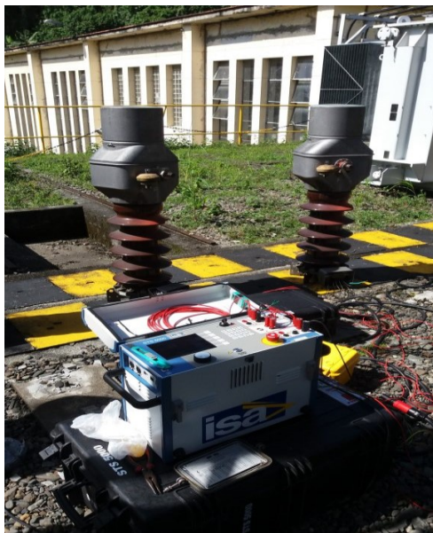
Figura 45. Transformadores de corriente (CTs)
