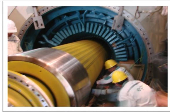
Figura 20. Rotor (General Electric) U1 de polos lisos entrando al Estator Central Termosierra EPM
