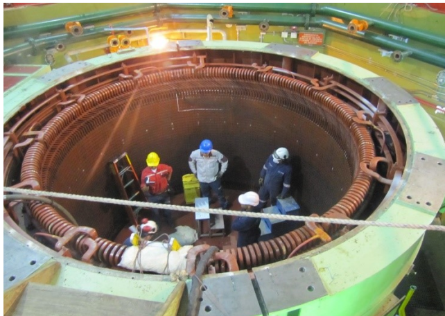
Figura 5. Estator del generador (R.K) 68 Mw
