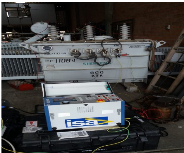
Figura 44. Transformadores de distribución
