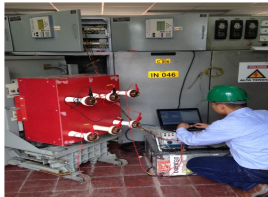
Figura 48. Pruebas en relés de protección Fuente: extraido de http://pti-sa.com.co/pruebas-en-reles-de-proteccion/
