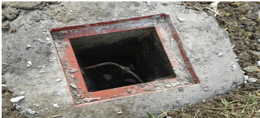
Figura 21. Caja de inspección.
