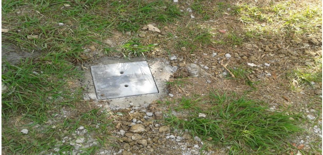
Figura 22. Caja de inspección con la tapa.
