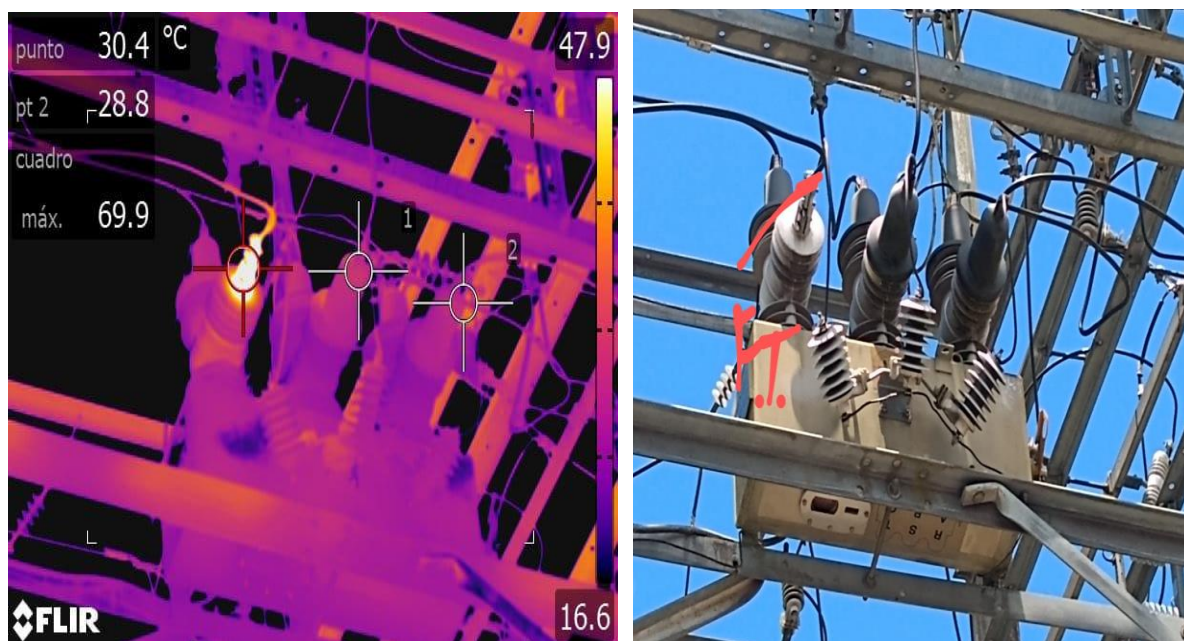
Figura 11. Termografía Punto Caliente Buje Primario
