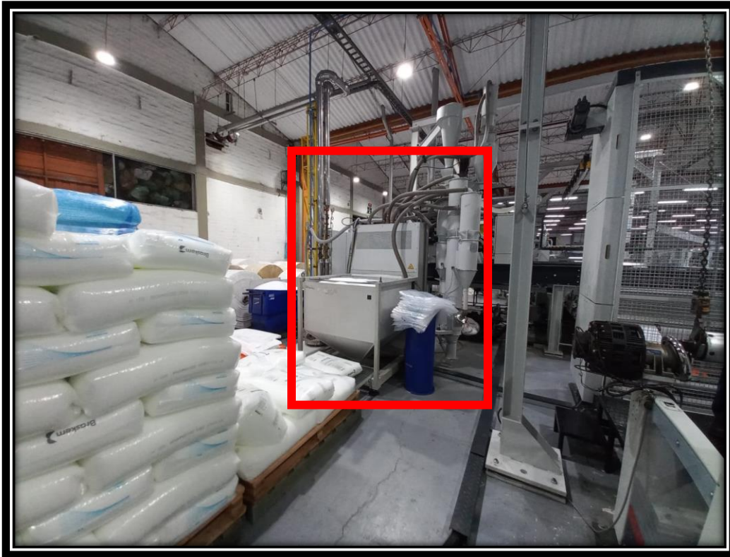
Figura 21. Tolva de la máquina laminadora 3
