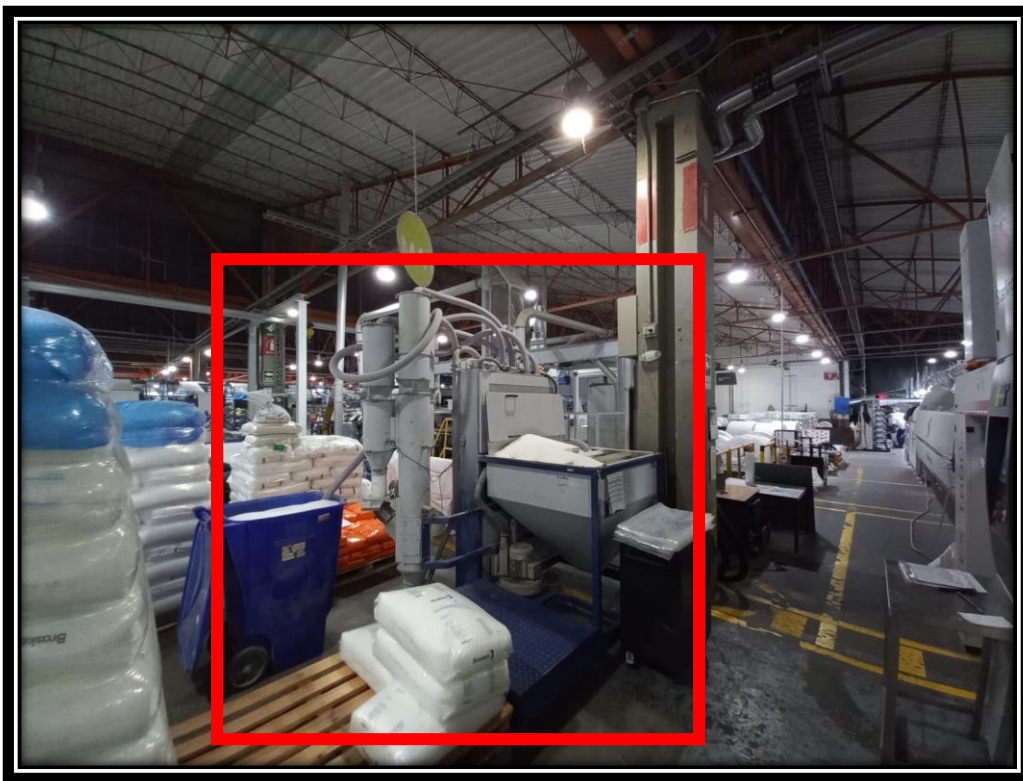
Figura 14. Área de la tolva
