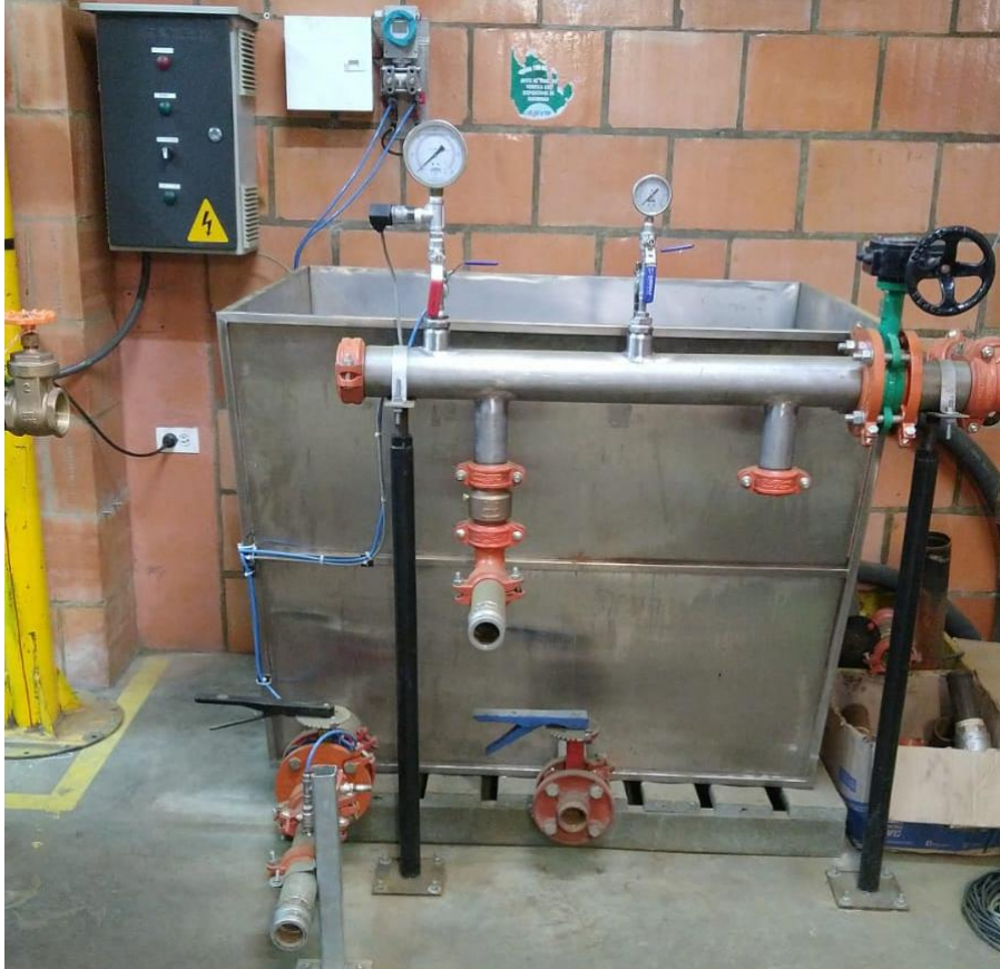
Figura 35 Banco de prueba BYR Ingeniería de fluidos Sede Bogotá
