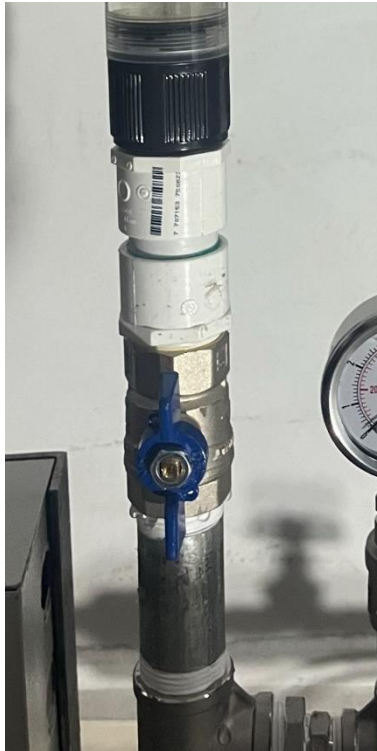
Figura 60 Válvula de bola abierta 100% Fuente: Elaboración propia
