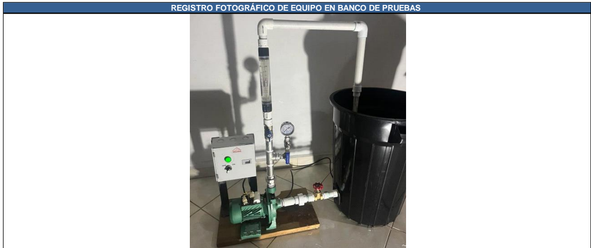
Figura 77 Bomba CPM130 instalada en banco para la prueba 3. Fuente: Elaboración propia “Informe banco de pruebas”
