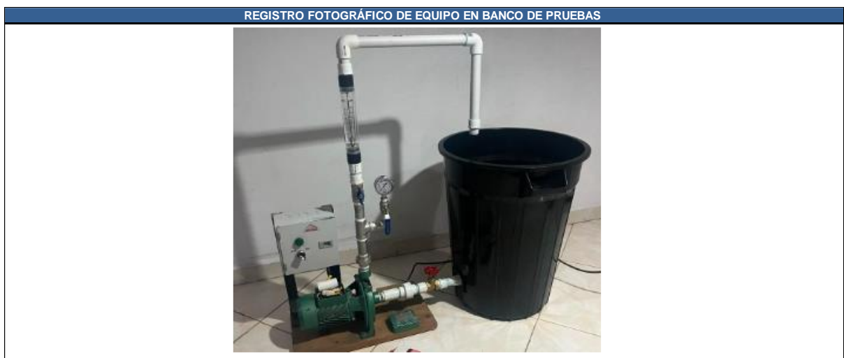
Figura 73 Bomba CPM130 instalada en banco para la prueba 2. Fuente: Elaboración propia “Informe banco de pruebas”
