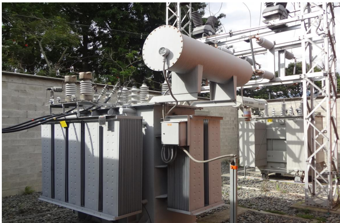
Figura 014: Los transformadores de la subestación principal - Industria de Alimentos.
