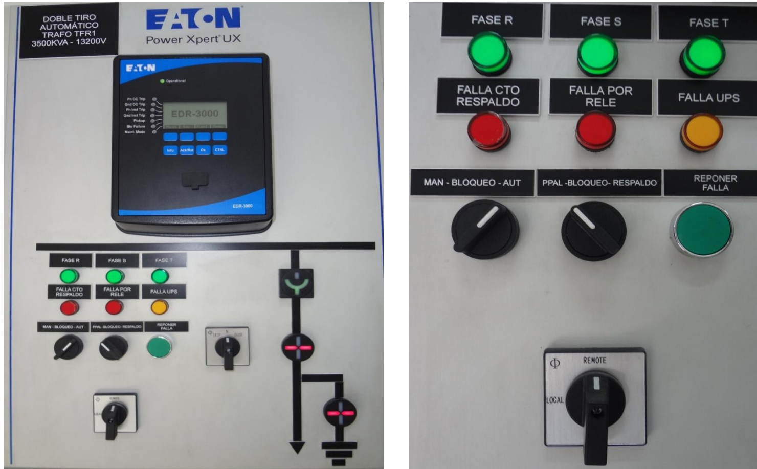
Figura 018: Equipos para el control automático de la subestación principal. - Industria de Alimentos.
