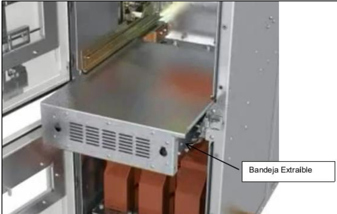
Figura 21: Extracción de bandeja del interruptor. [01]
