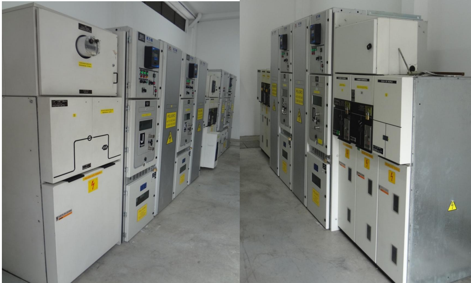
Figura 015: El centro de distribución de potencia eléctrica y el control automático. - Industria de Alimentos.
