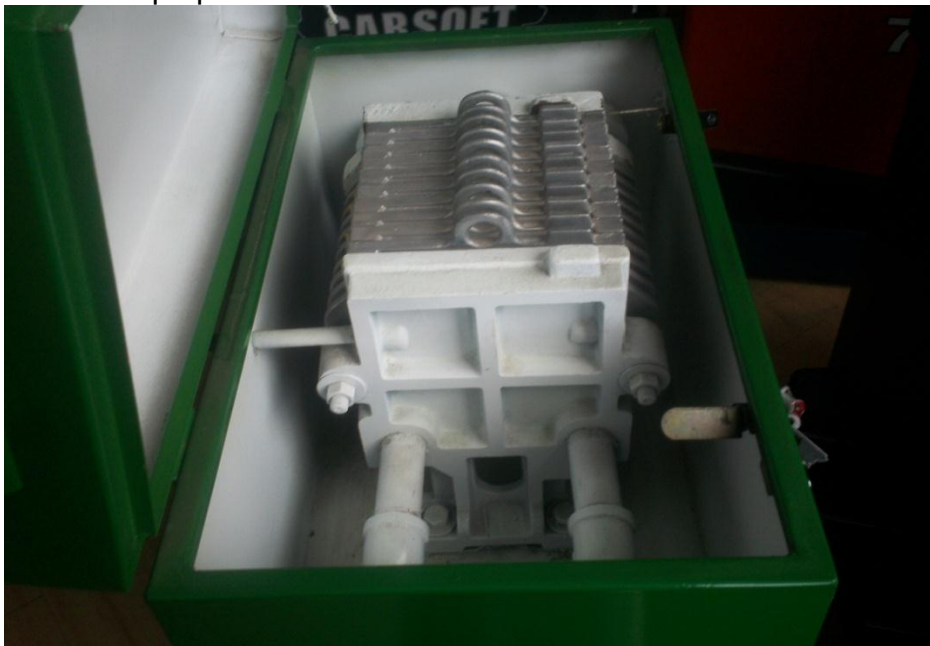
Figura 40. Filtros tipo prensa instalados.
