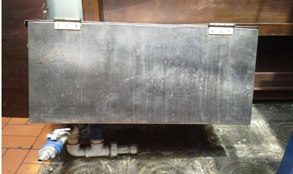
Figura 39. Tanque de almacenamiento.
