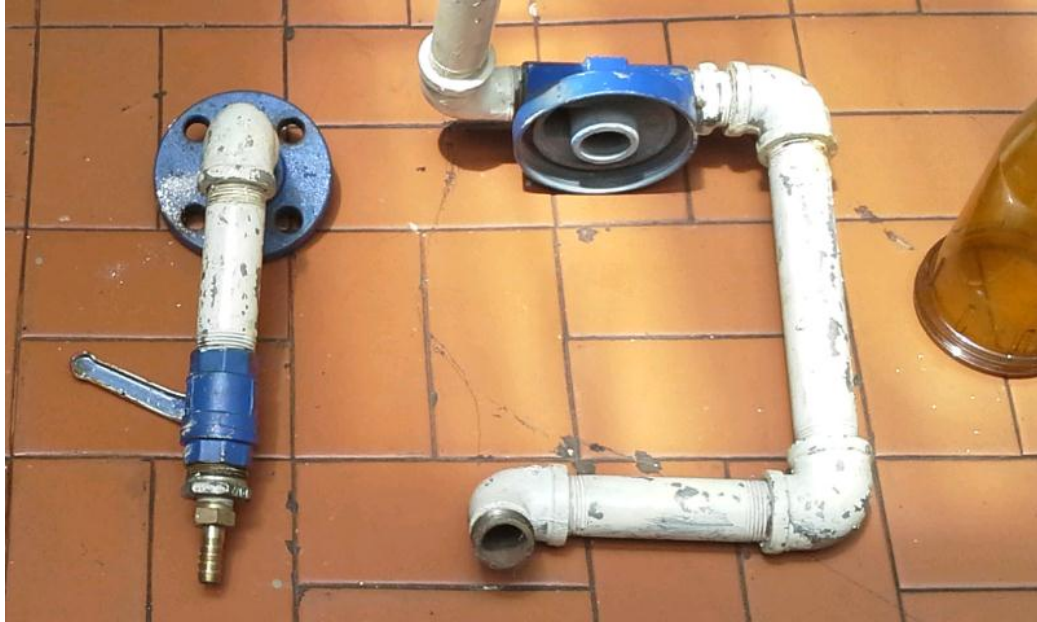
Figura 35. Llave de drenaje y tuberías de prefiltro.
